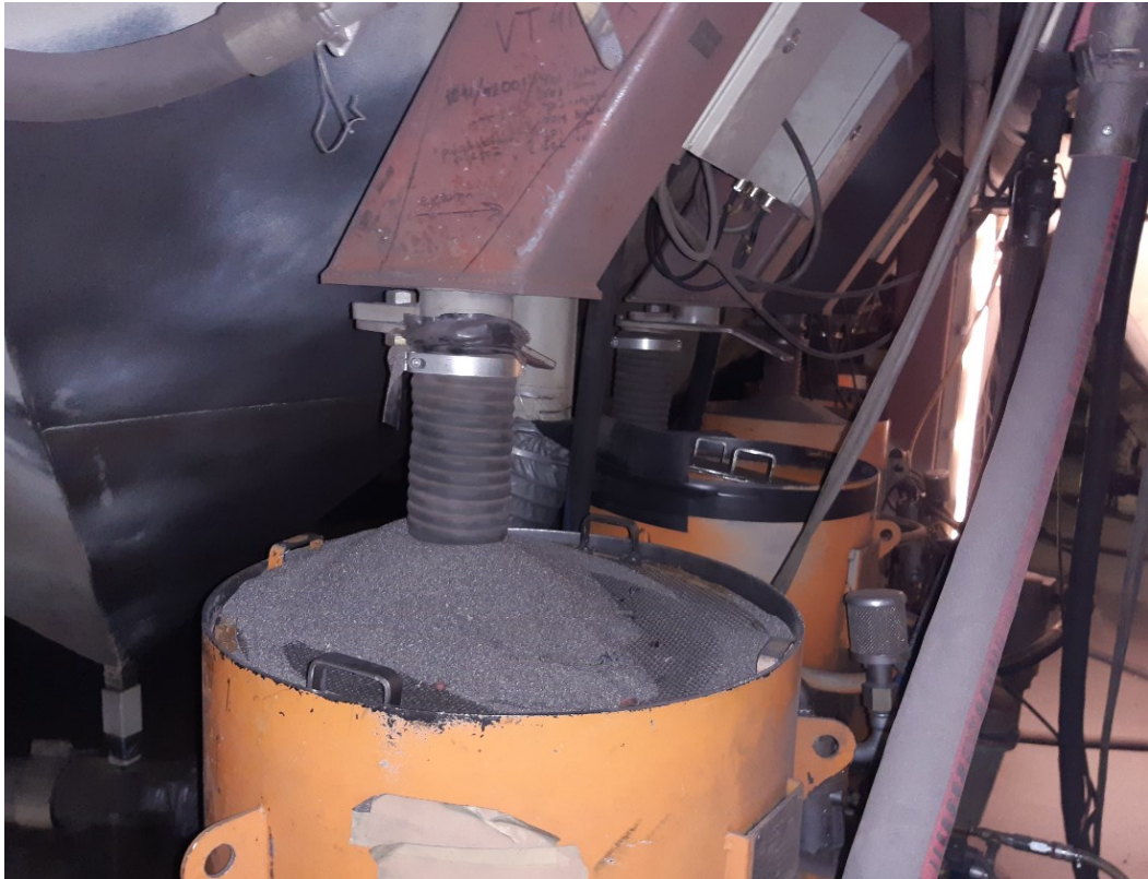
Kuva 17. Raepuhaltamon alla olevat pytyt, joista puhdistettu rae lähtee uusiokäyttöön. Pyttyjen päällä on ritilä, joka erottaa mahdolliset painavat rakeen mukana tulleet roskat, kuten koneistuslastut.
