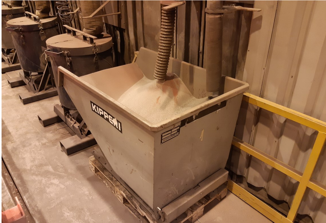
Kuva 18. Astia, johon syklonissa erotettu tavara tulee puhaltamon katolta.
