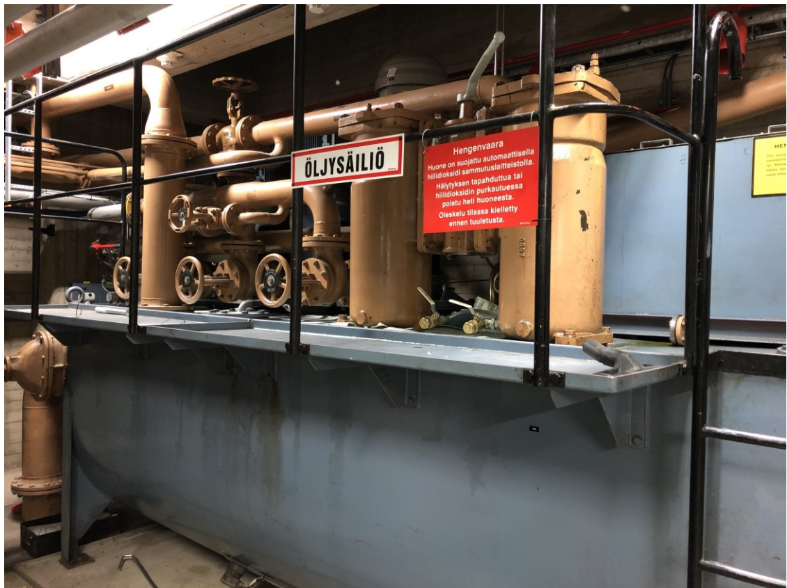
Kuva 5. Vanajan varavoimalaitoksen voiteluöljysäiliö. Säiliön päälle on sijoitettu voiteluöljyn pumput, suodattimet ja öljylinjastojen venttiilit. Etualalla, kylttien takana, näkyvät kaksi lieriötä ovat öljynsuodattimia.
