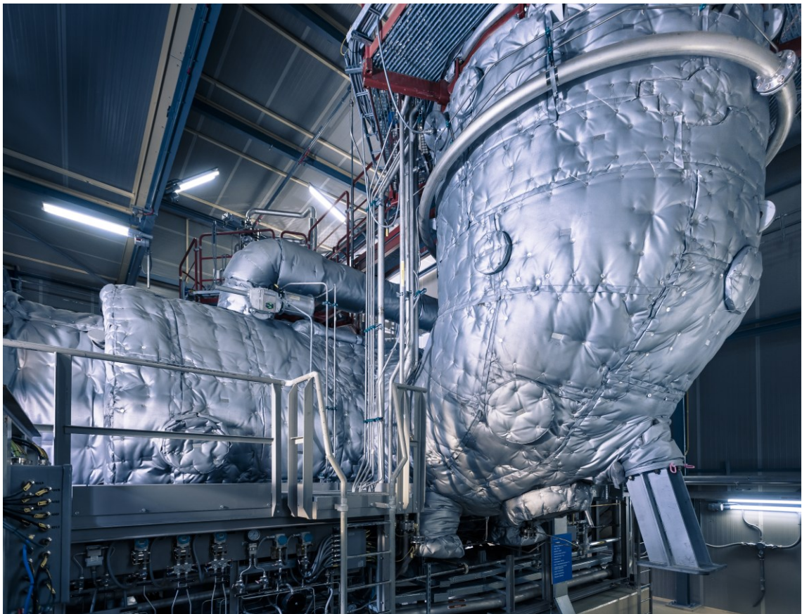
Kuva 4. Ansaldo V94.2 -kaasuturbiini. Kuvan etualalla pystyyn kohoava lämpöeristetty osa on toinen turbiinin polttokammioista.
