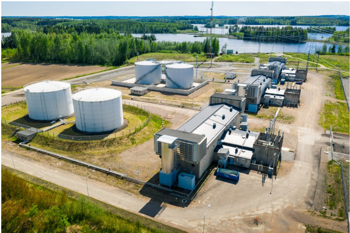
Kuva 1. Huutokosken varavoimalaitos. Kuvassa on varavoimalaitoksen kuusi yksikköä ja polttoainesäiliöt.
