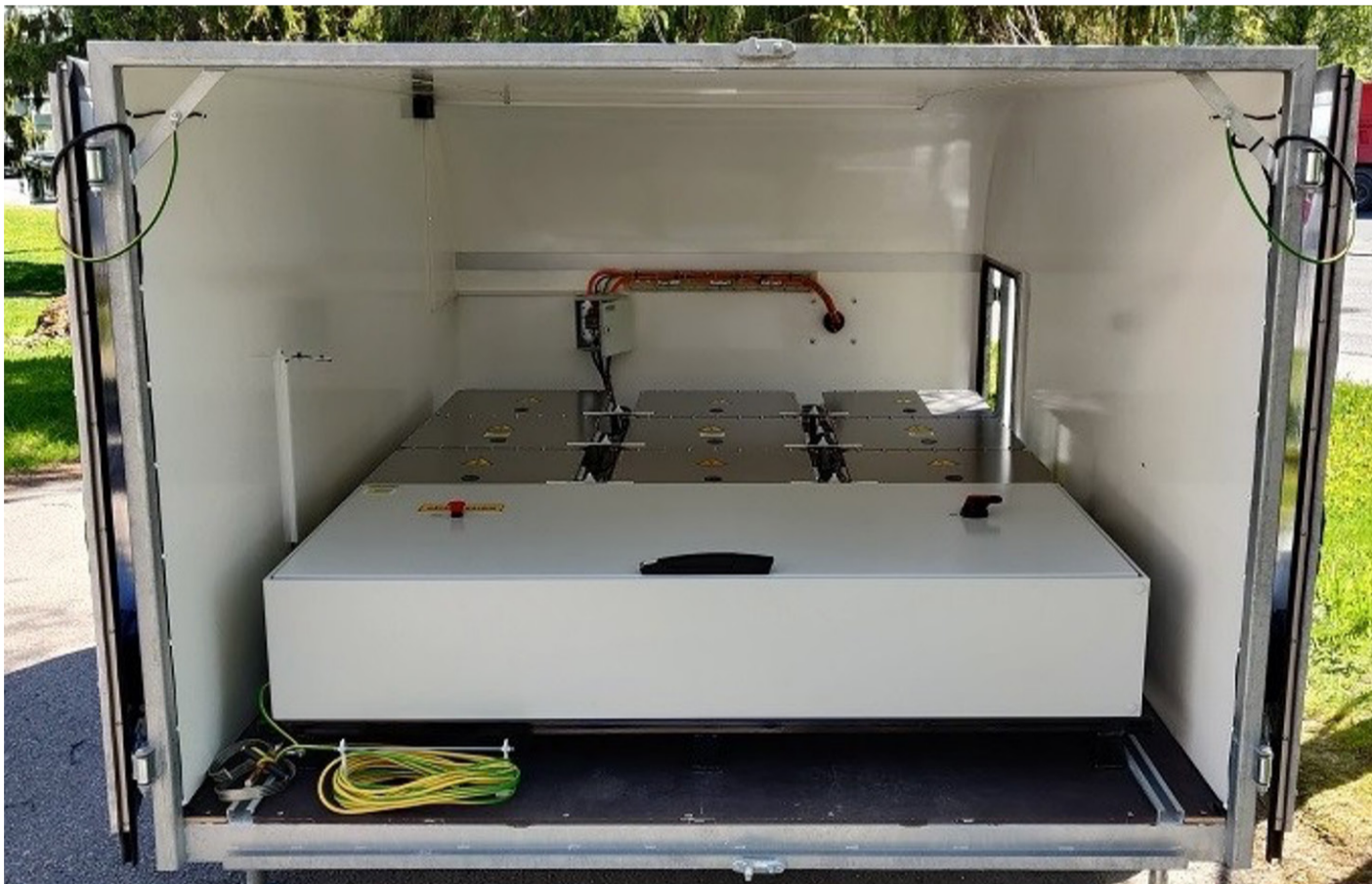
KUVA 4. Kurkistus energiavarastovaunuun: takana yhdeksän akkumoduulia teräslaatikoissaan, ja edessä sähkökaappi, joka sisältää tarvittavat kytkennät ja turvalaitteet sekä akkujenhallintajärjestelmän.
