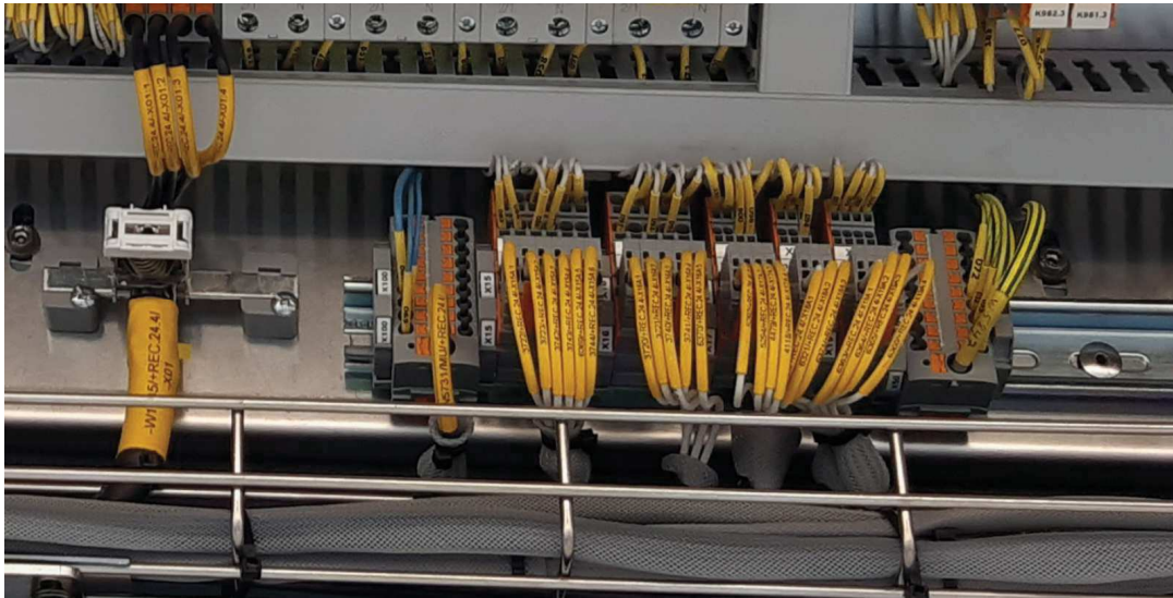
KUVA 34. Kaapeli- ja johdinmerkinnät laitelevyllä
