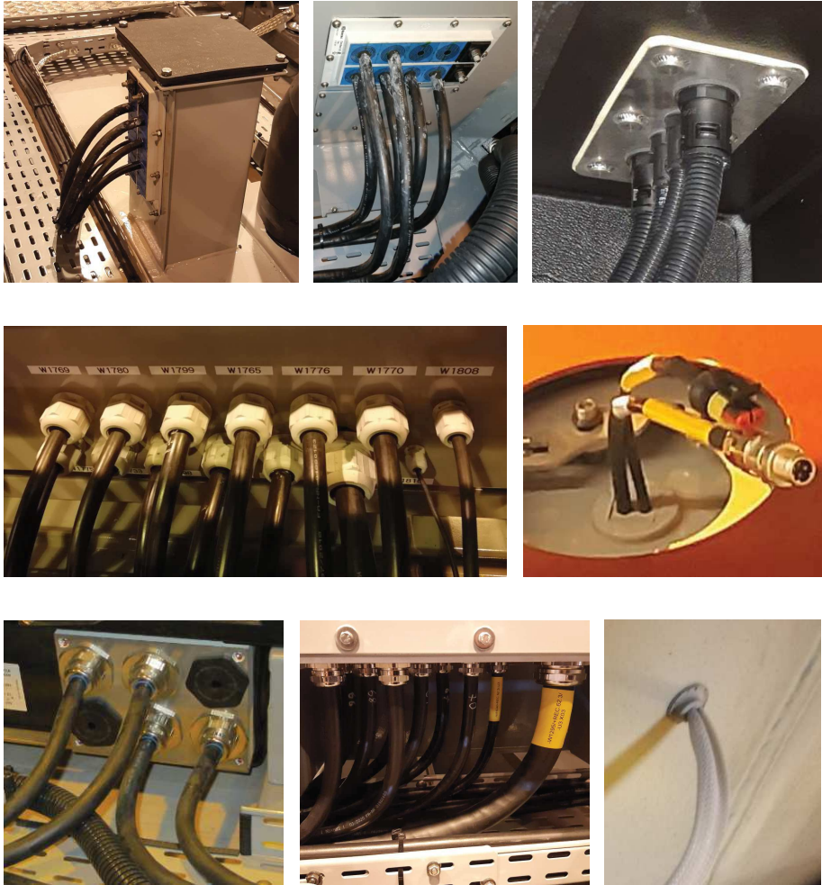
KUVA 21. Erilaisia kaapeliläpivientejä raitiovaunussa
