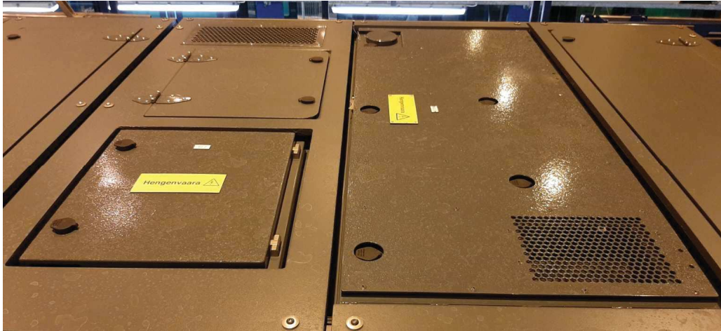
KUVA 37. Sähkökoteloiden sähkövaaramerkkejä katon huoltoluukuissa
