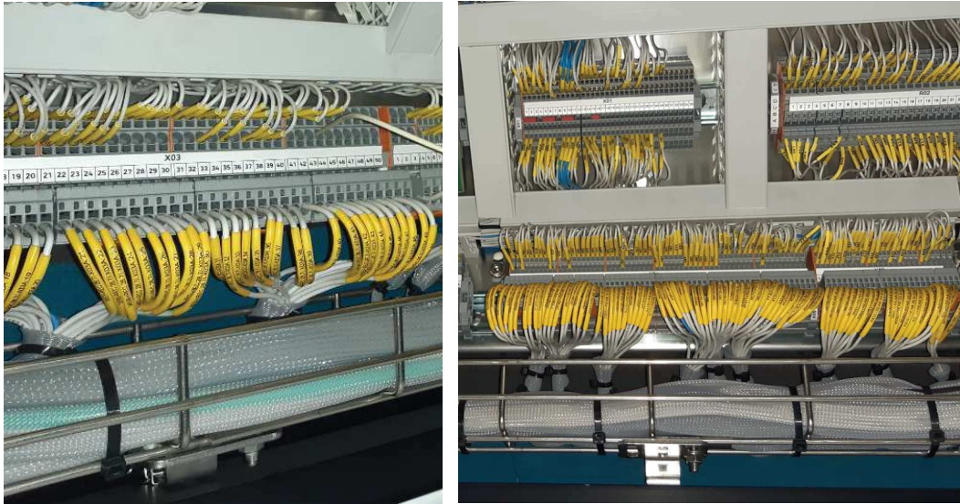
KUVA 29. Johtosarjan johtimia kytkettynä laitelevyille pistokelittimillä ja laitelevyjen sisäistä johdotusta kytkettynä jousikuormitteisilla liittimillä
