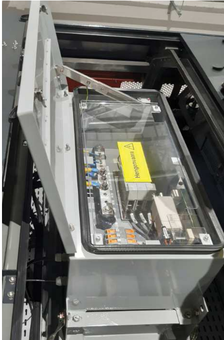
KUVA 36. Sähkökotelon kosketussuoja ja sähkövaaramerkki
