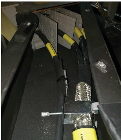
KUVA 10. Suojatun kaapelin häiriömaadoitus ja paluuvirta- ja syöttökaapeleiden asennus metalliseen koteloon raitiovaunun sisätiloissa
