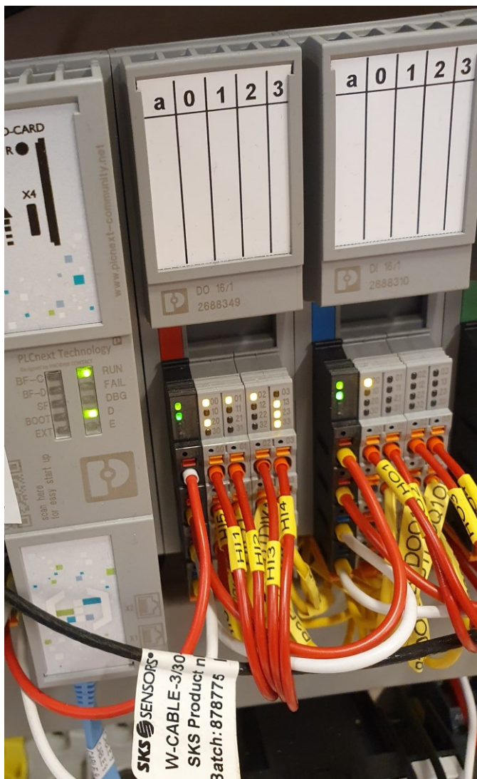
Kuva 11. Axio-line PLC:n digitaaliset lähdöt ja tulot.
