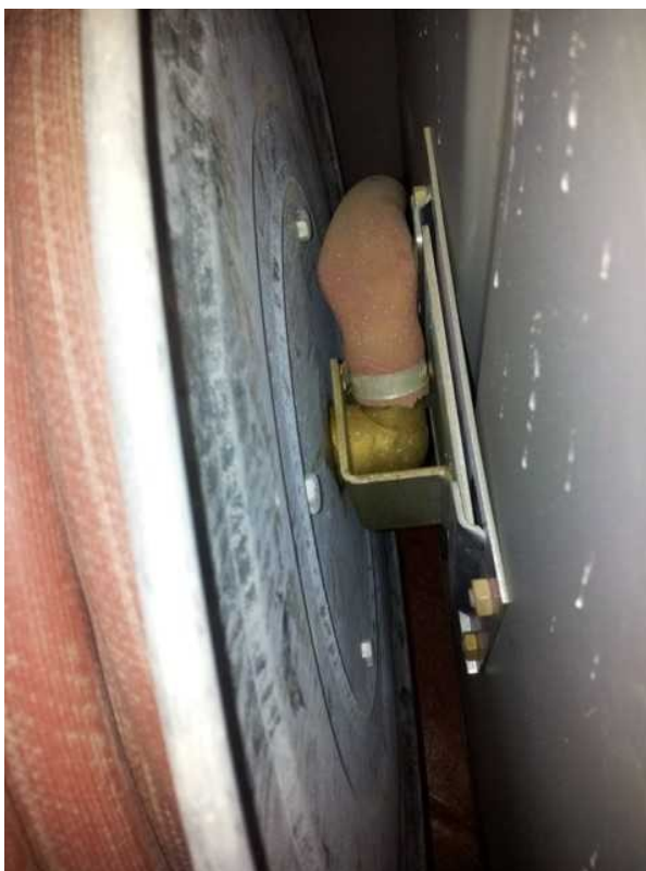
Kuva 13. Vesi ei pääse virtaamaan vapaasti letkussa, jos letku on painunut [1].
