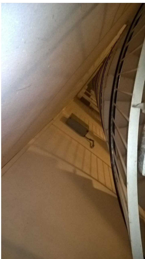
Kuva 11. Pikapaloposti sijoitettu portaikon seinälle [1].
