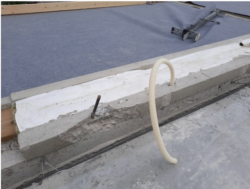
KUVA 2. Sähköputken sijaitessa elementin ulkopuolella kyseessä on elementtivrhe
