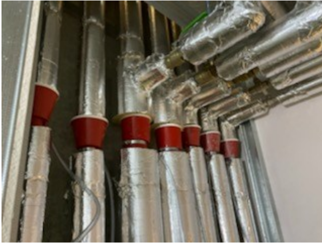
KUVA 15. Tekniikkakuilun putkilinjojen vuodonilmaisimet
