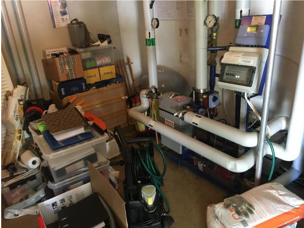
Kuva 27. Kuvassa lämmönjakohuone ja kaukolämmön siirrin lähtötilanteessa.
