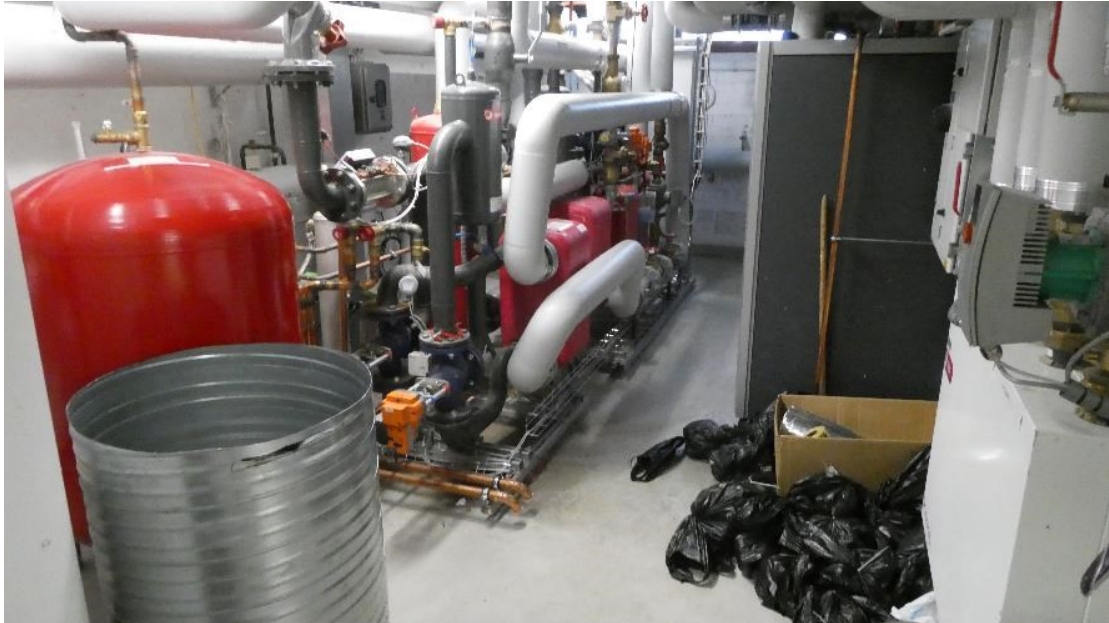
Kuva 5. Kaukolämmön ja poistoilmalämpöpumpun muodostama hybridijärjestelmä.
