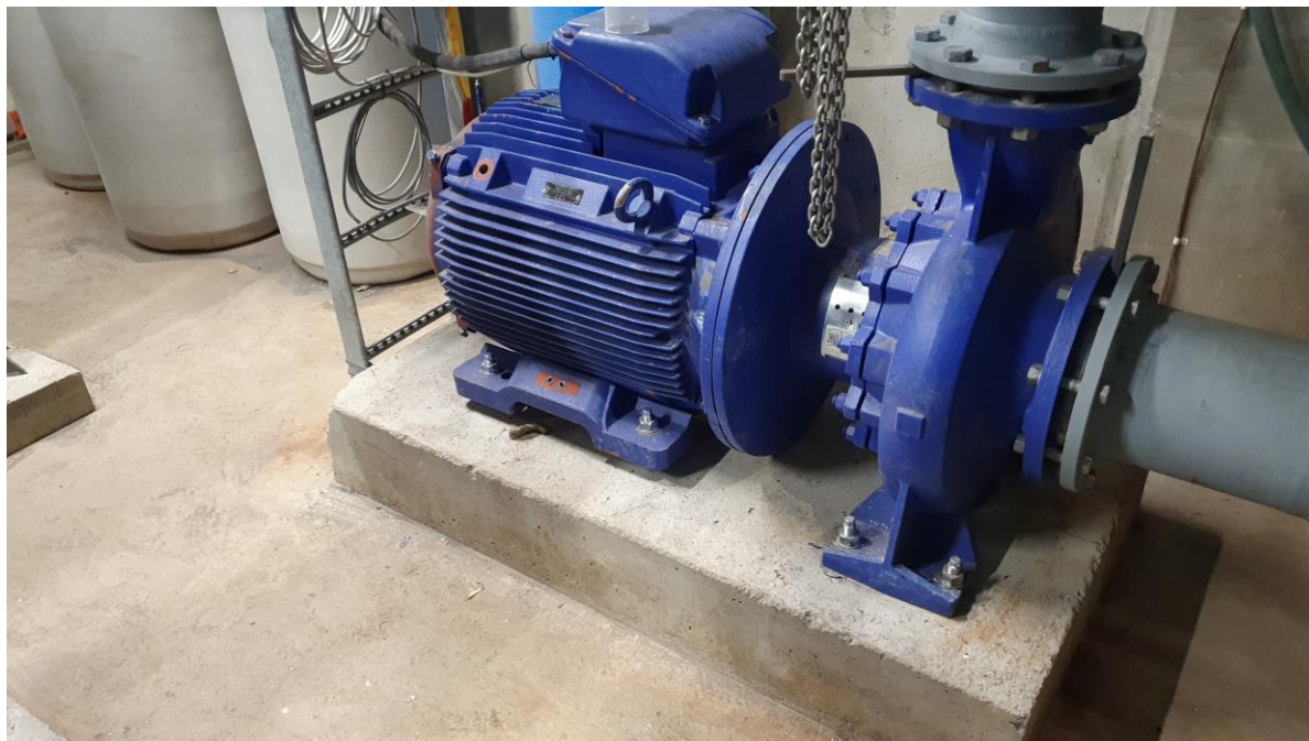
Kuva 11 Linjattu juurivalua odottava glykolipumppu
