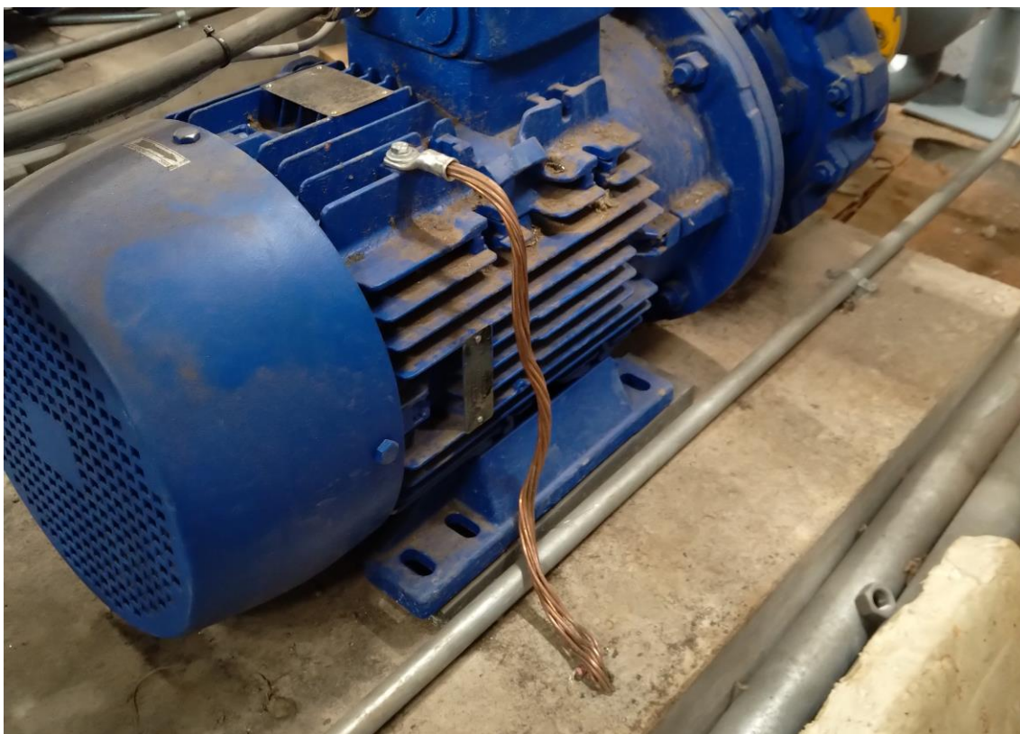
Kuva 15 Oikosulkumoottorin rungon lisämaadoitus suoraan perustuksista
