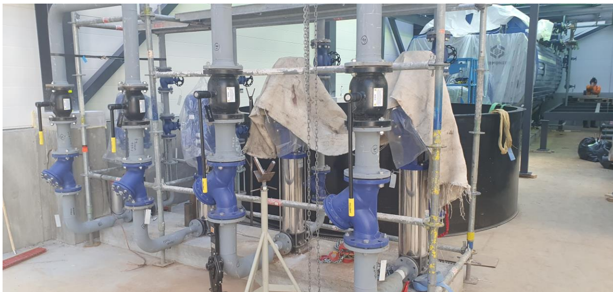
Kuva 10 Syöttövesipumput – 2 kpl biokattila, 2 kpl maakaasukattila kesällä 2020
