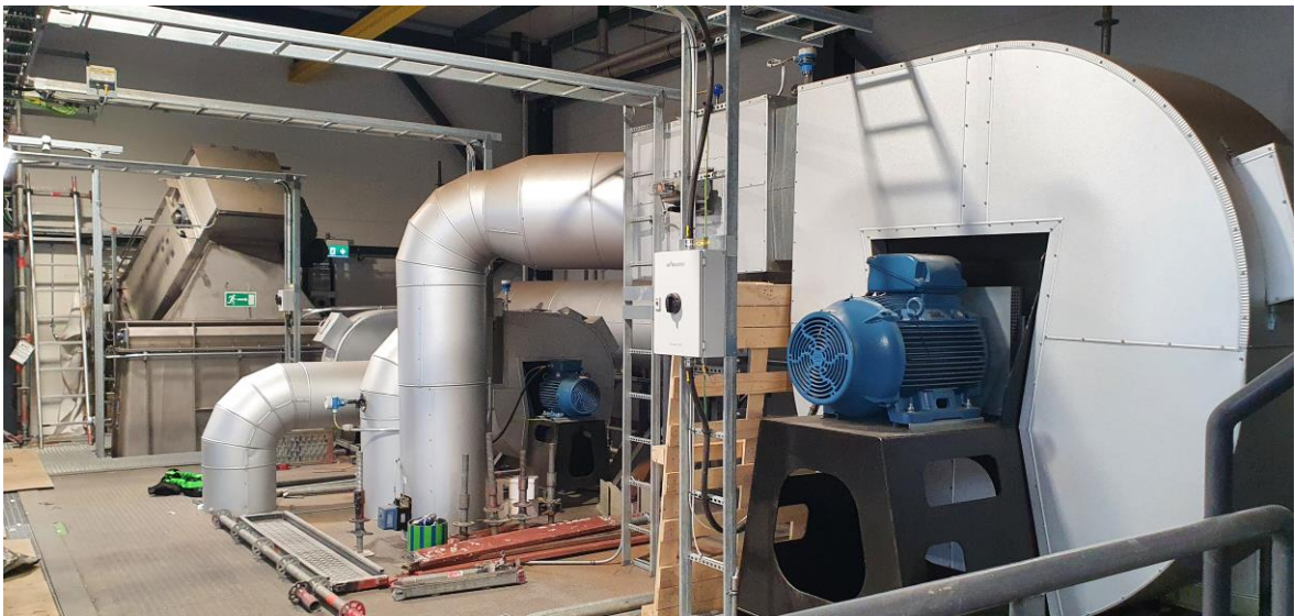
Kuva 13 Tulipesän päälle sijoitettu puhallinryhmä; primääri-, sekundääri- ja kiertokaasupuhallin
