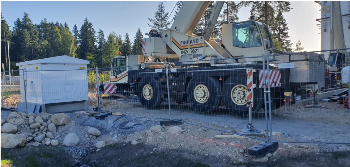
Kuva 4 Laitosta tehdasalueen verkosta syöttävä keskijännitemuuntaja
