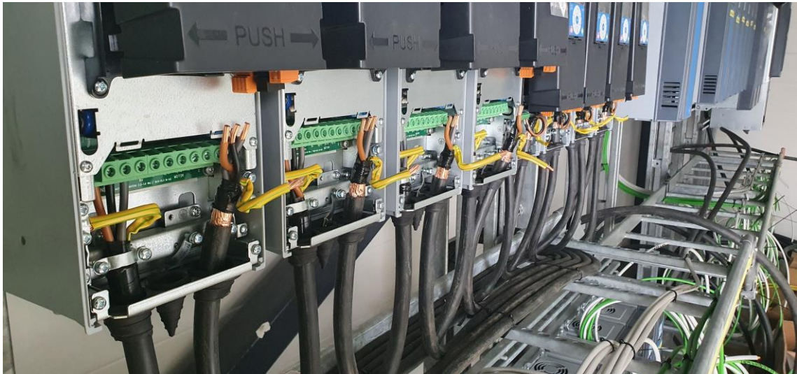
Kuva 17 Lähteviä moottorikaapeleita taajuusmuuttajilta.
