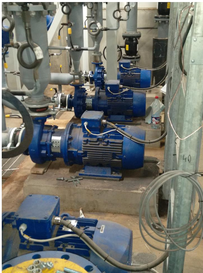
Kuva 9 Keskipakopumppuja asennuksessa laitoksella syksyllä 2020
