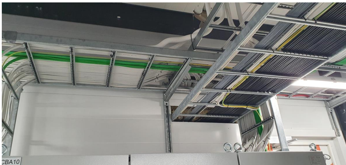
Kuva 20 Automaatiotilan kaapelihylly, jossa moottorikaapelit (MCCMK) ovat omalla hyllyllään ja signaalikaapelit (Nomak) omallaan sekä vielä aukinainen palokatko
