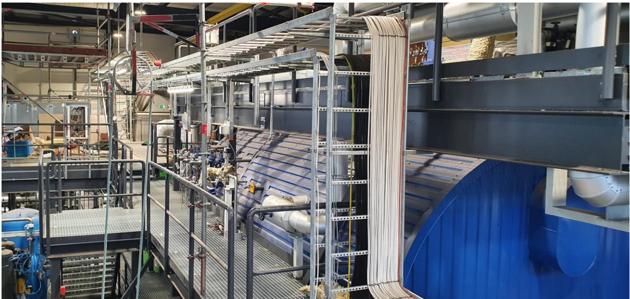
Kuva 22 Kaapelihylly, jossa signaalikaapelit (Nomak) sekä syöttökaapelit (MCCMK) omilla hyllyillään
