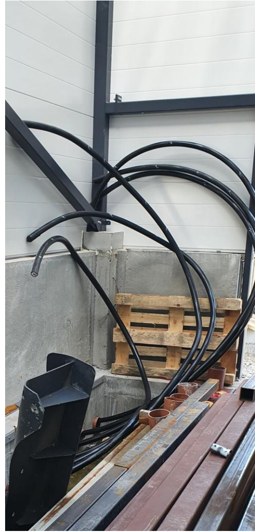
Kuva 7 Laitoksen pienjännitesyöttökaapelit sähkötilassa muuntajalta
