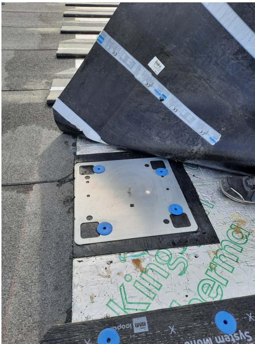
Figur 9. Här ser man fästplatta för livlinefäste. Takpappen viks här över plattan och sammanfogas med föregående, detta syns i bildens nedre kant.
