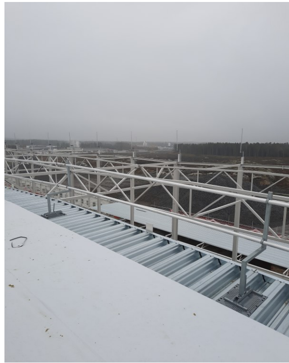
Figur 11. Skyddsräcke, skruvad i takplåten.
