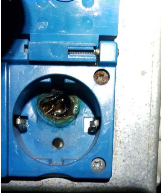
Kuva 4. Työmaakeskuksen vaurioitunut pistorasia.
