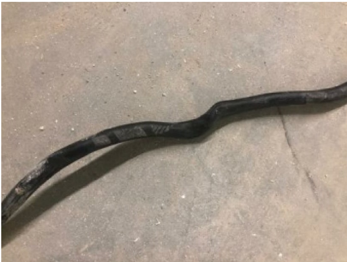
Kuva 7. Vaurioitunut jatkojohto haalausreitillä.
