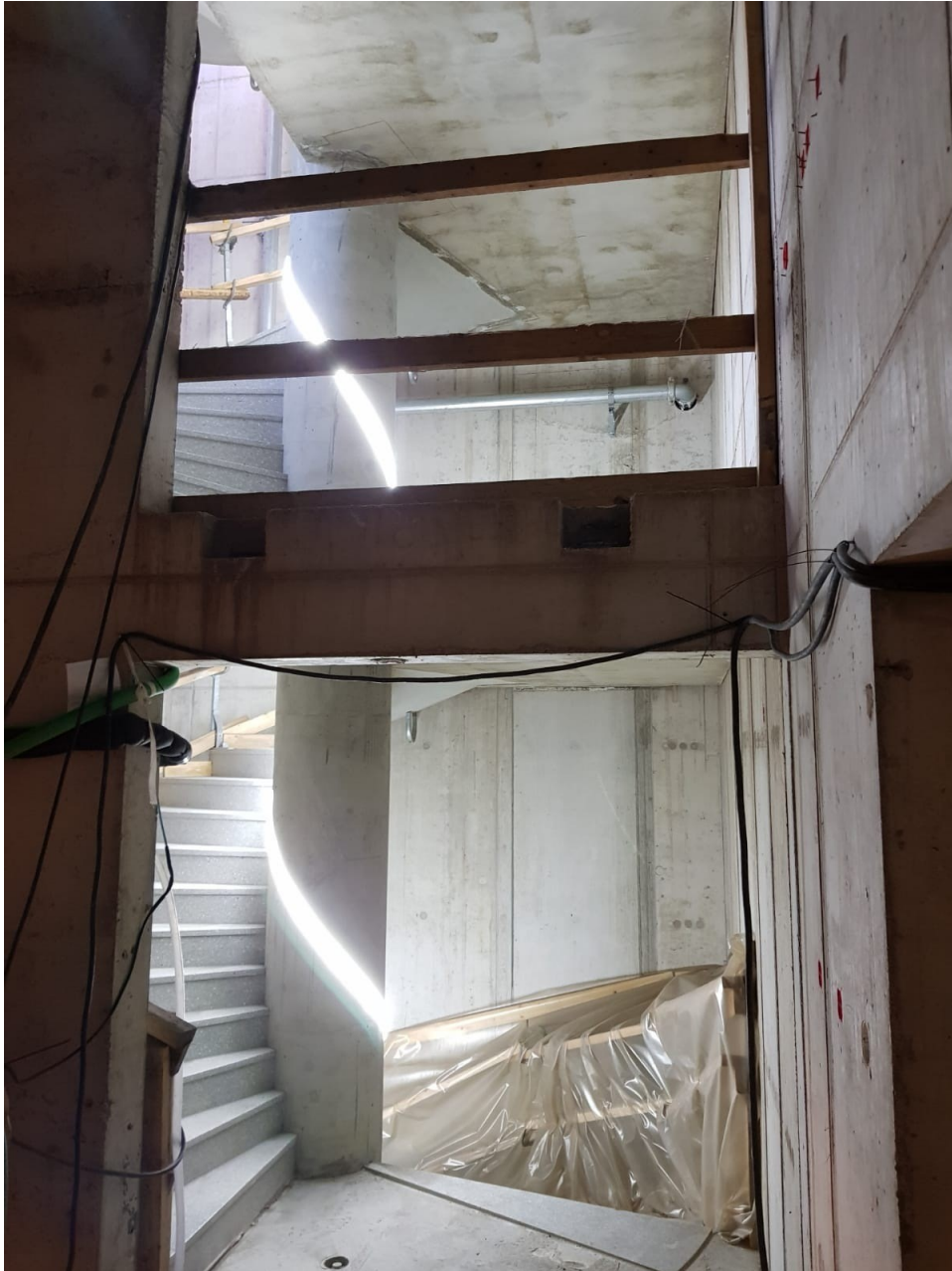
Kuva 5. Espoon Lippulaiva, porraskäytävän valaisu LED-nauhalla.
