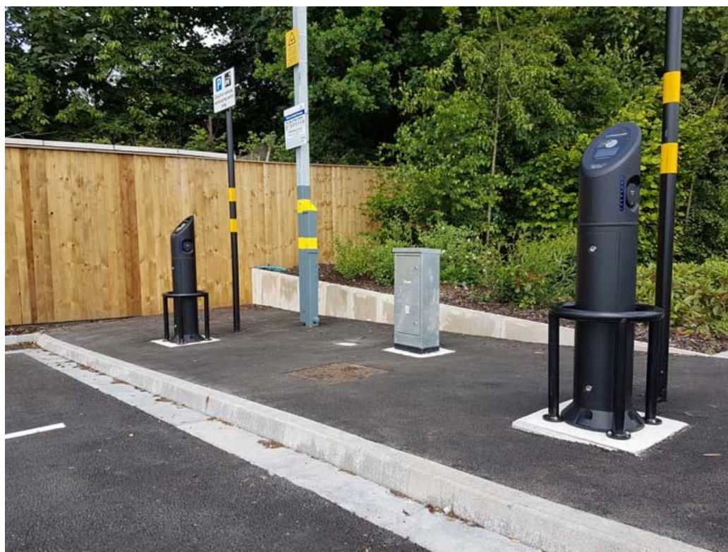
Kuva 26: Suojaputket asennettuna sähköautojen latauslaitteiden eteen tuomaan lisäturvaa (EV (Electric Vehicle) Barrier And Bollard Protection Products 2021)
