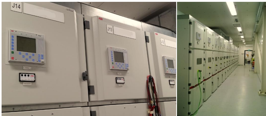
Kuva 14. Kärmeskydön sähköaseman 20 kV kojeisto.
