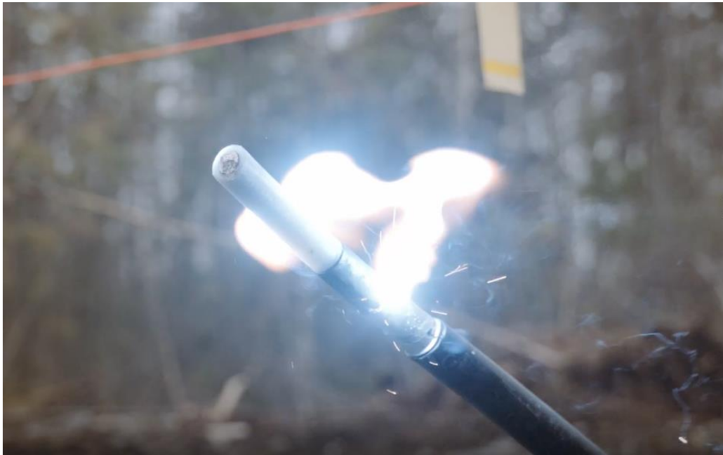
Kuva 17. Katkeileva maasulku testikaapelissa.
