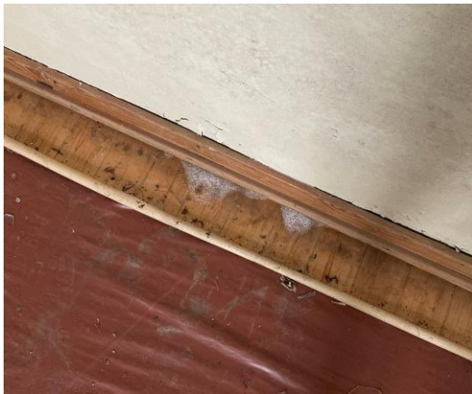
Kuva 20. Lattianrajassa havainto kosteuden aiheuttamasta jäljestä.
