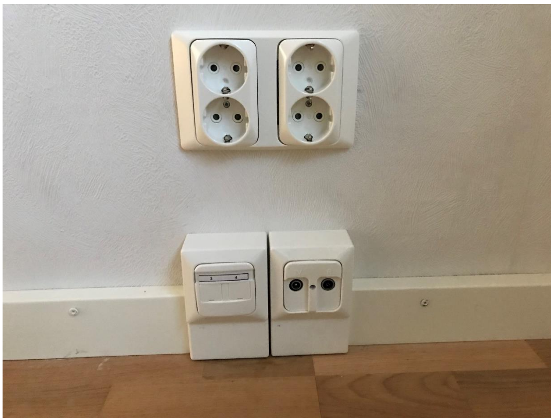
Kuva 6. Yhteisantenni- ja ATK-rasia-asennus (Kaasinen 2020)
