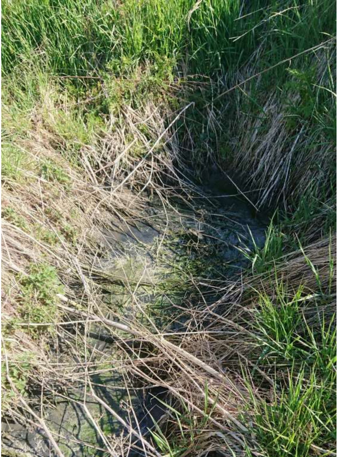
Kuva 7. Hanhialantien vieressä oleva tukkeutunut ojarumpu. Kuva: Juuso Kosonen.
