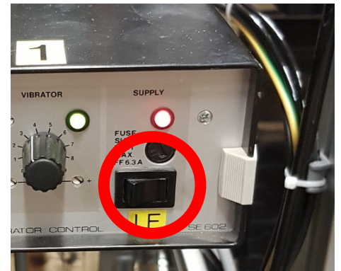
Kuva 18 Syöttökanavan täristimen virtakytkin
