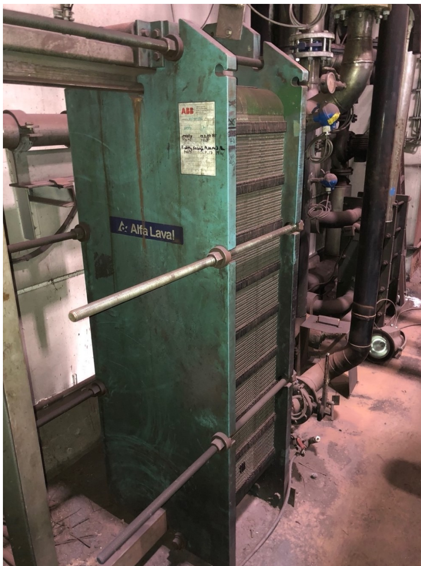
Kuva 4. Aurubis Finland Oy:n kuparivalssaamon jäähdytystunnelin lämmönsiirrin Alfa Laval M15-BFM8.
