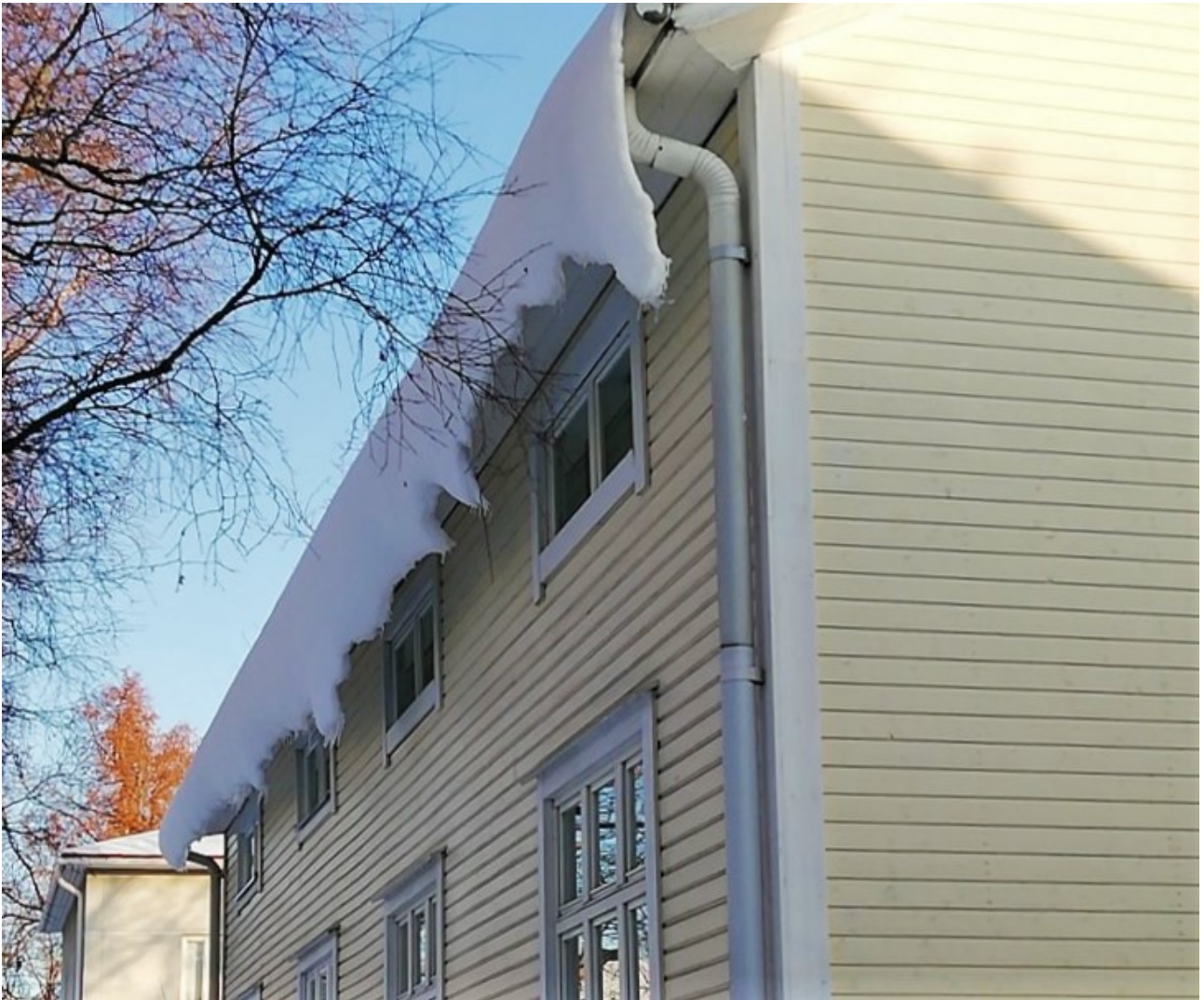
KUVA 3. Lumi roikkuu katolta vaaraa aiheuttaen (kuva: Aarno Taskila 2019)
