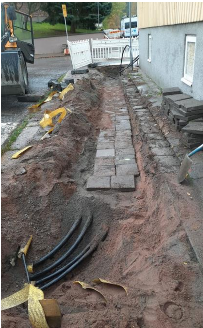
Kuva 6. Betonilaatalla suojattu pienjännitekaapeli (Tatu Kinnunen, 2020)
