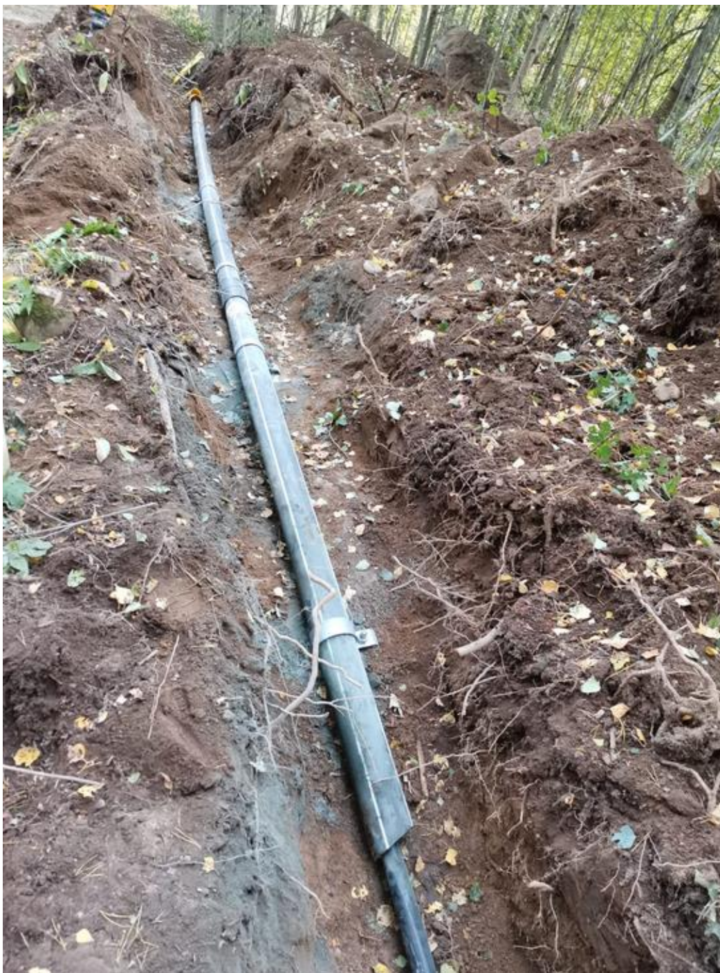
Kuva 7. SRE-putkella suojattu pienjännitekaapeli (Tatu Kinnunen, 2020)
