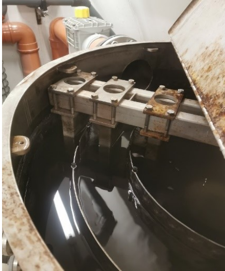
Kuva 19. Therm-X lämmönsiirrinlevyt, harjat sekä jäteveden poistoyhde.
