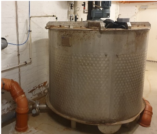
Kuva 20. 90-luvulla asennettu Therm-X LTO.
