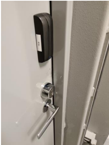
Kuva 8 Irtaimistovarastotilaan johtavan oven käyttölukon murtautumisläpät.
