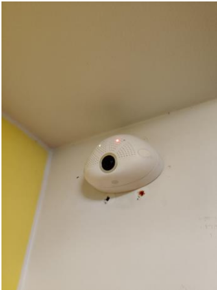
Kuva 6 Porraskäytävässä sijaitseva valvontakamera.
