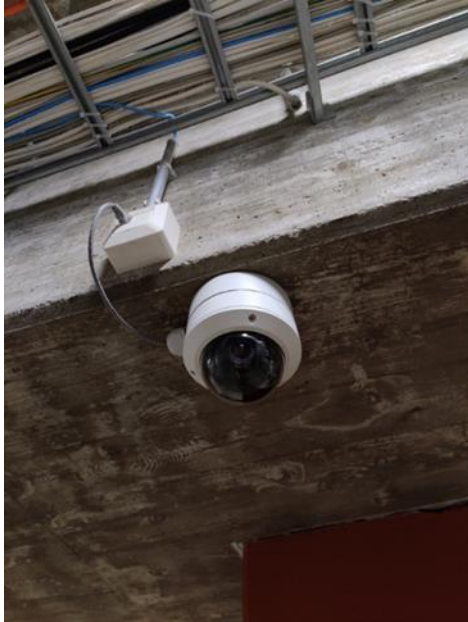
Kuva 3 Parkkihallissa sijaitseva valvontakamera.
