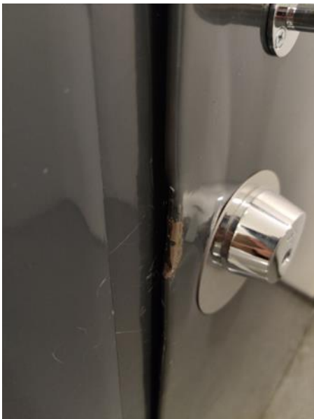
Kuva 7 Irtaimistovarastotilaan johtavan oven käyttölukon murtautumiset.
