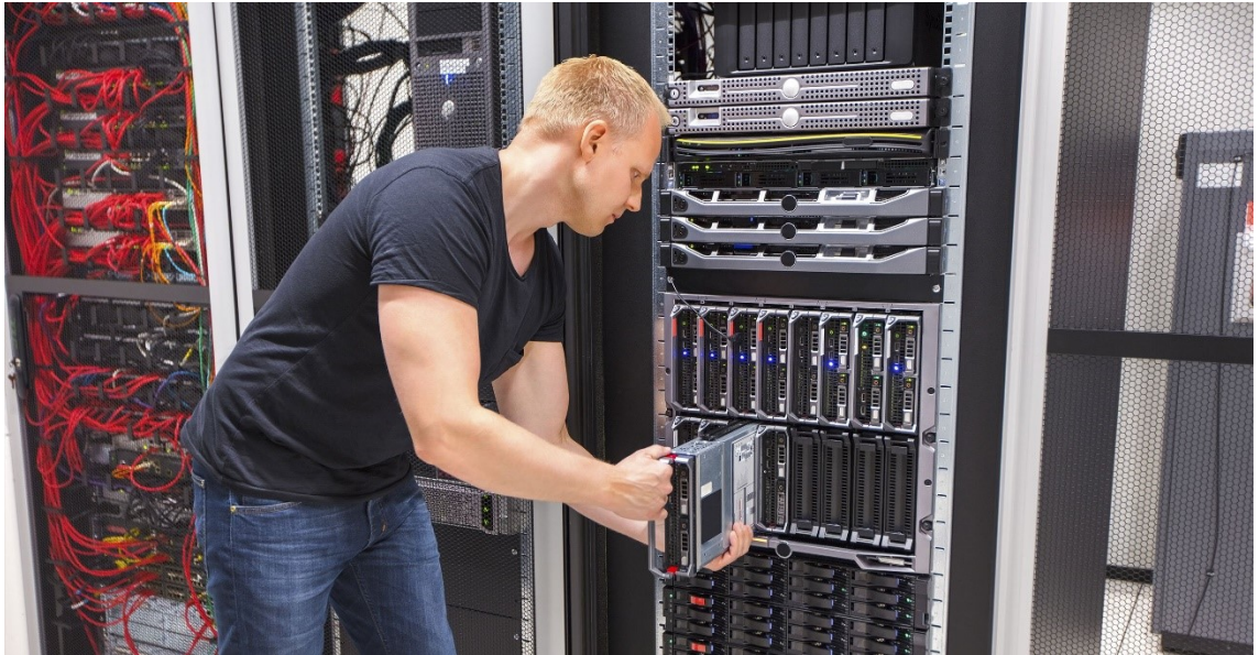
Kuva 2. Räkkiteline, jossa on sekä blade- että rakkiservereitä (Kolbjornsrud)
