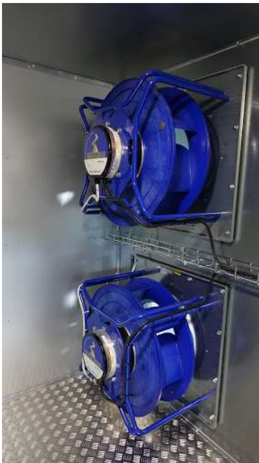
Kuva 6. Kaksi EC-kammiopuhallinta asennettuna samaan ilmanvaihtokoneeseen (Mastervent 2021).
