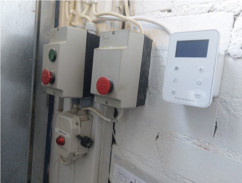
KUVA 19. Kiertoilmapuhaltimen kojeet, vasemmalla vanhat ja oikealla nykyinen säädin.
