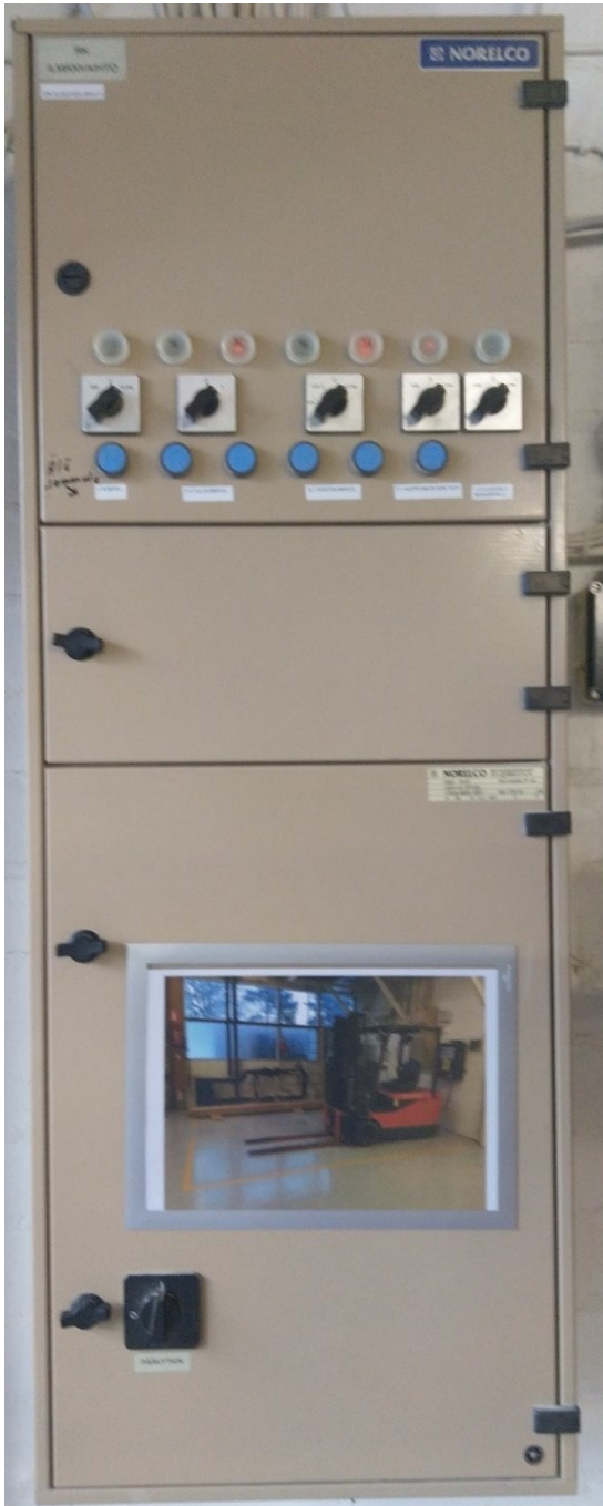
KUVA 7. RK Ilmanvaihto, moottorilähtöihin liittyvät kytkimen ja merkkivalot keskuksen yläosassa.
