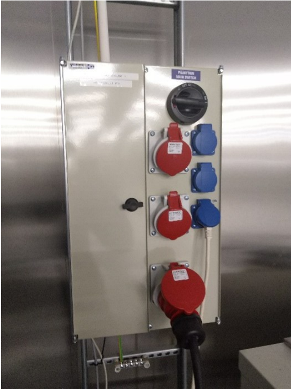
KUVA 10. Pistorasiakeskus 1, olosuhdelaboratorion laitteita varten asennettu keskus.
