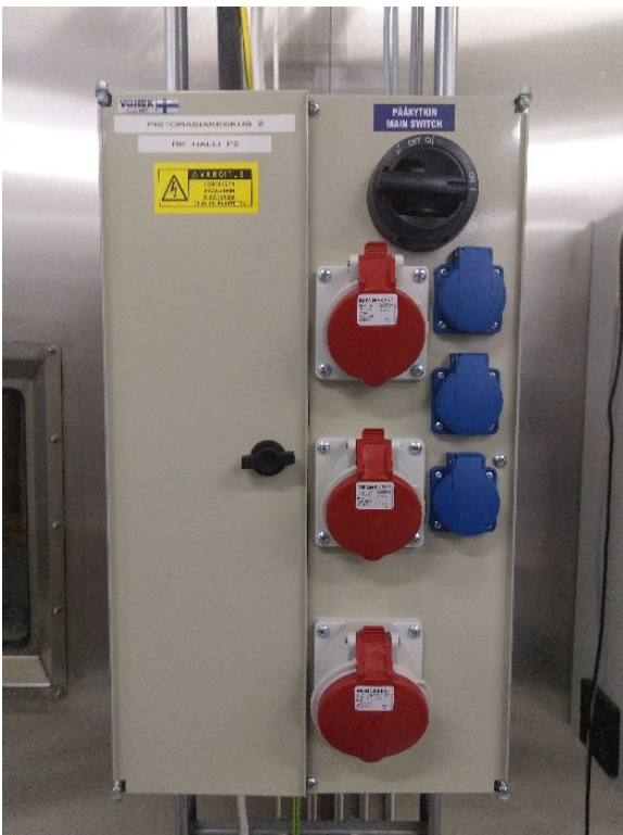
KUVA 11. Pistorasiakeskus 2, olosuhdelaboratorion laitteita varten asennettu keskus.
