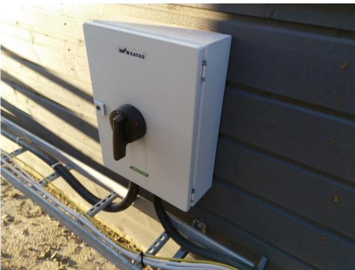
KUVA 13. Olosuhdelaboratorioon liittyvän jäähdyttimen katkaisija.
