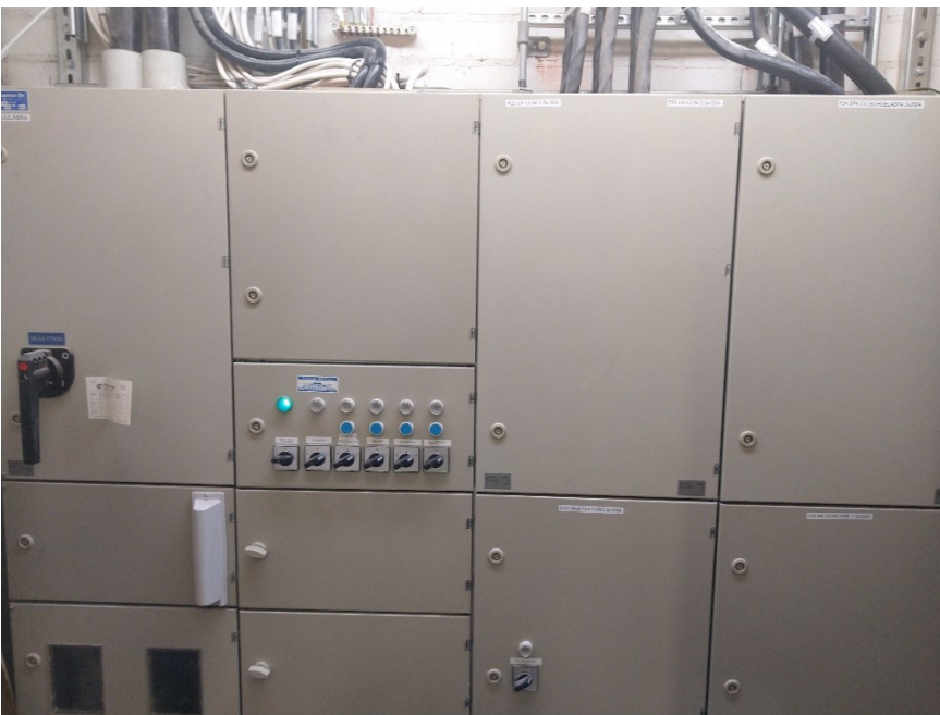
KUVA 15. MK Puulabra, pääkytkin, tariffimittari, moottorilähtöjen kytkimiä ja merkkilamppuja.
