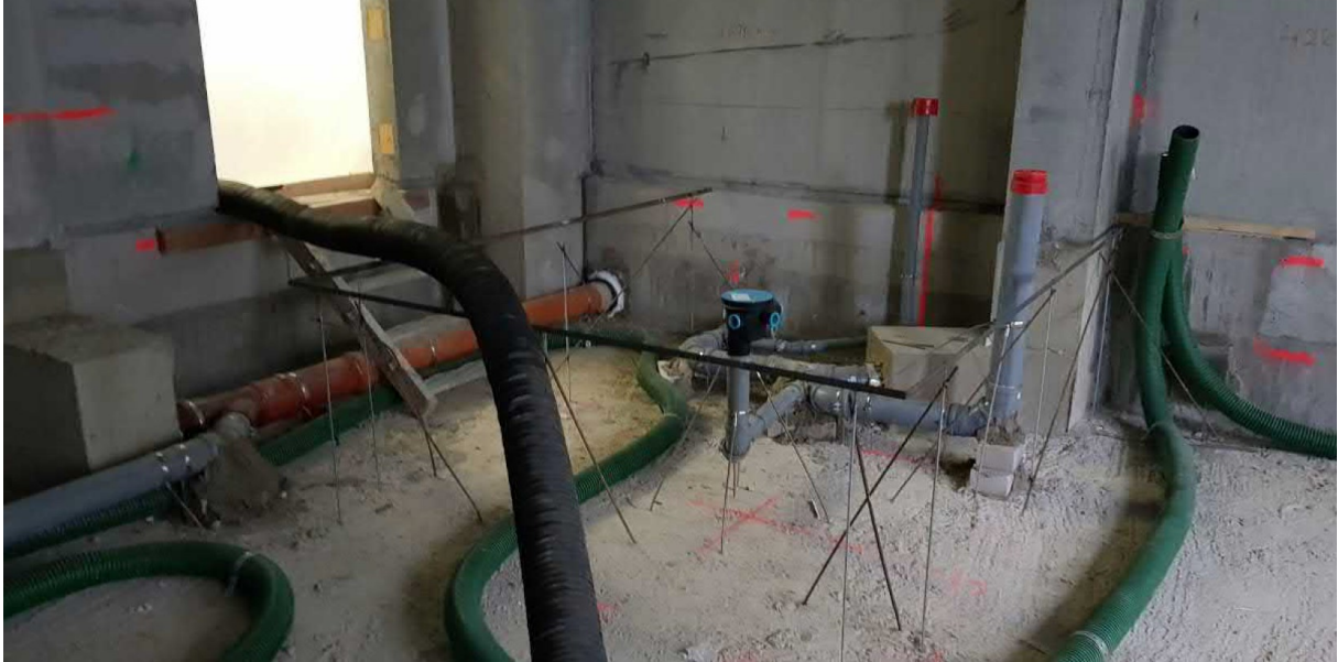
Kuva 4. Tekniikkatilan asennuksia ja tuuletusputkisto
