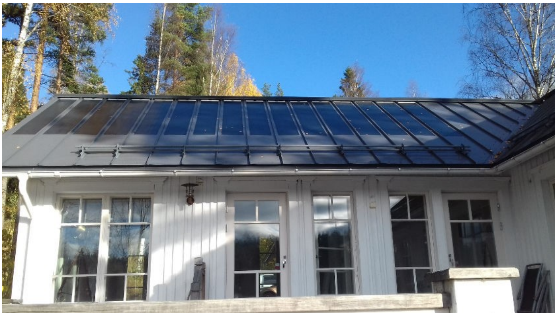
Kuva 9. Virte Solarin 8,3 kWp:n aurinkosähköjärjestelmä [15].
