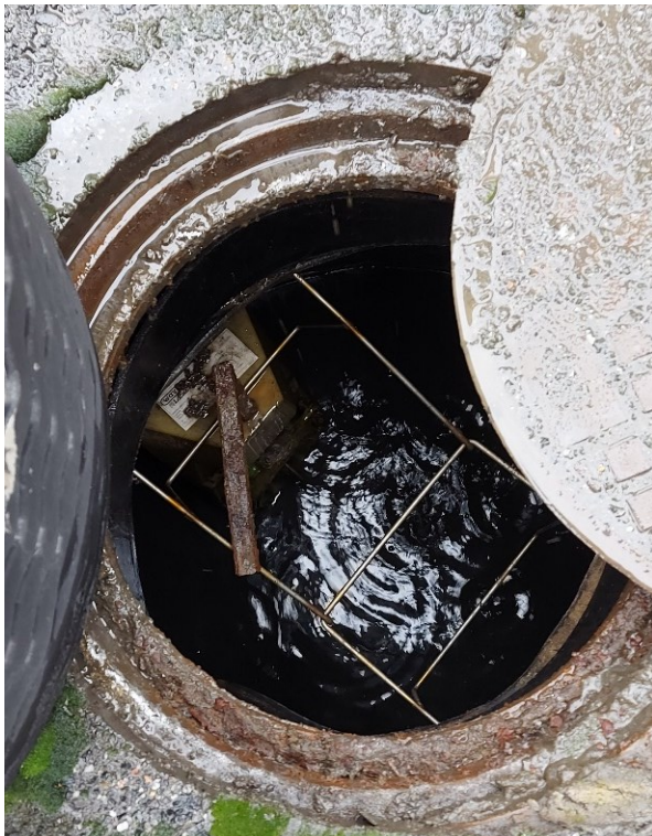
KUVA 18. Sulkukaivon venttiilin auki-kiinni-merkintä sekä kaivonkannen merkintä puuttuu (Saarelainen 2020).
