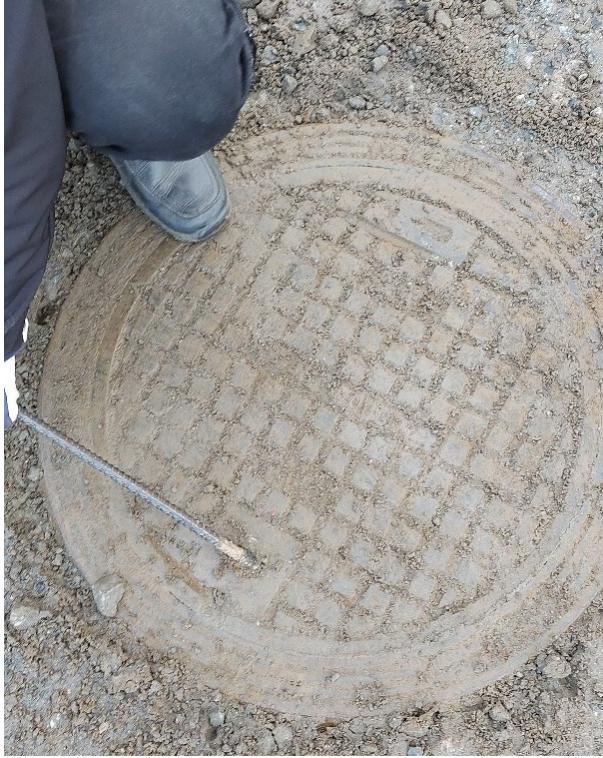
KUVA 17. Keltainen öljynerottimen merkintä puuttuu öljynerottimen kaivonkannesta (Saarelainen 2020).
