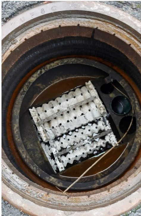
KUVA 16. Siisti öljynerotin, jossa hälytin toimii sekä lisäksi öljynerottimessa on suodattimet (Saarelainen 2020).
