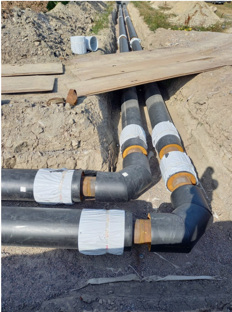
Kuva 1. Kuvassa jatkoseristeitä vaille olevat kaukolämpöputket.
