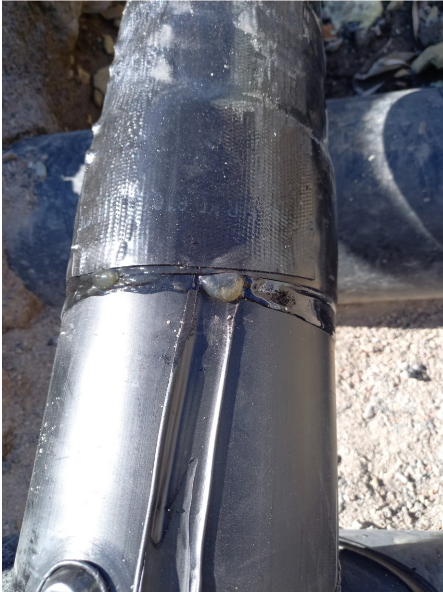
Kuva 16. Muovihitsatun kulman hitsaussauman koloon on sulatettu oikeaoppisesti kunnolla liimaa ja saumaa hiottu tasaiseksi, jottei sinne pääse vesi.
