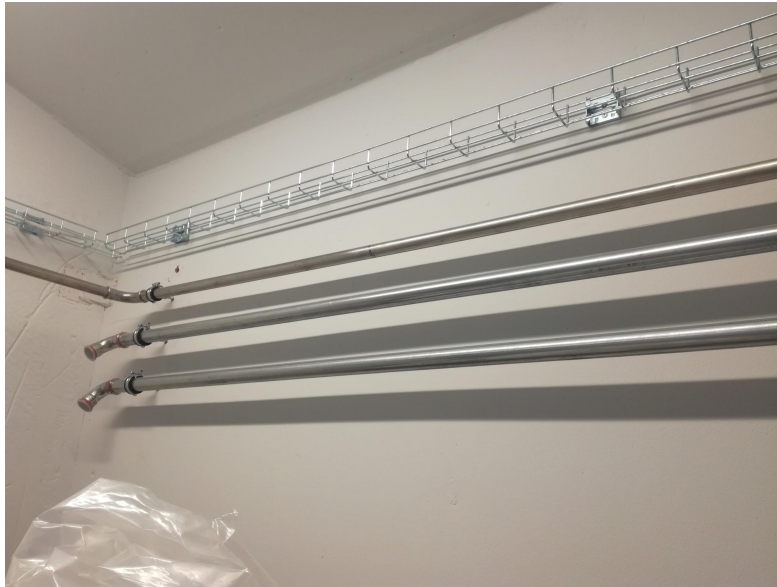
Figur 33. Rördragning ovanför pannan.
