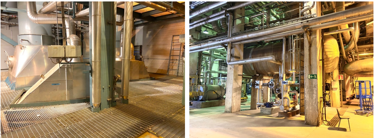
KUVA 21. Höyryluvot ja lauhteenkeräyssäiliö
