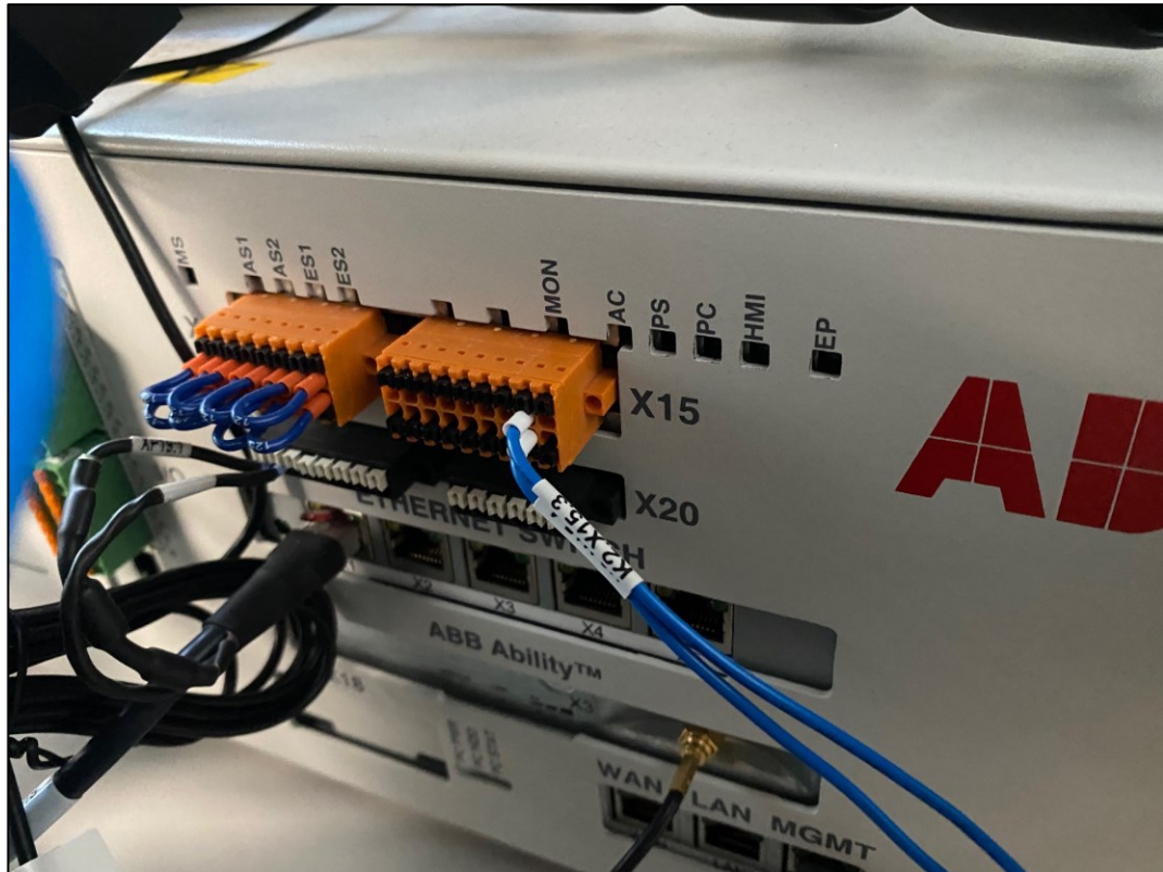
Kuva 16. ABB:n IRB14050 -robotin I/O-portit.
