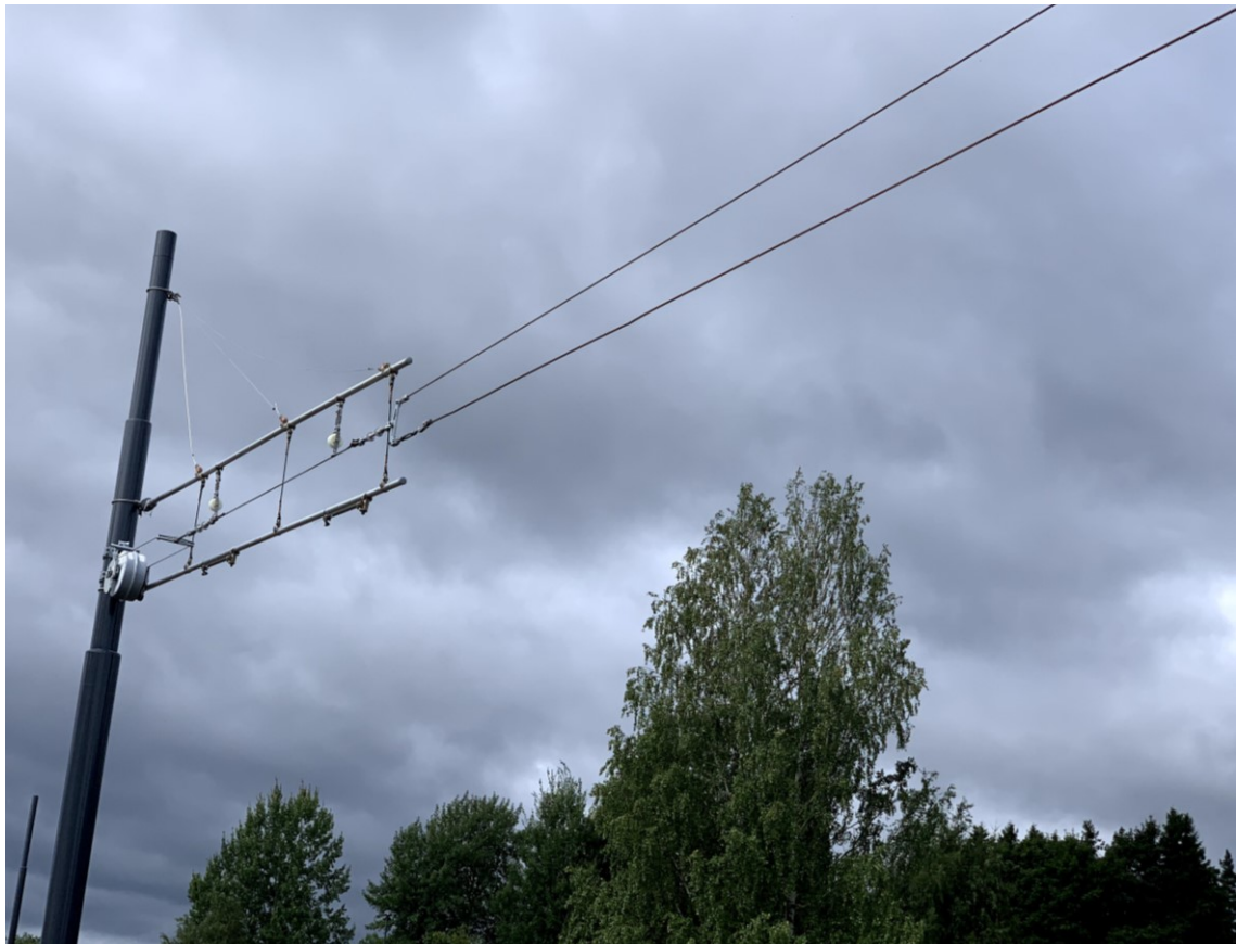
Kuva 14. Jousikiristyslaite asennettuna sähköratapylvääseen. Kiristyslaite on kytketty ajolankaan ja tukijohtimeen, joita se vetää 1600 kg voimalla pitäen johteet kireänä.
