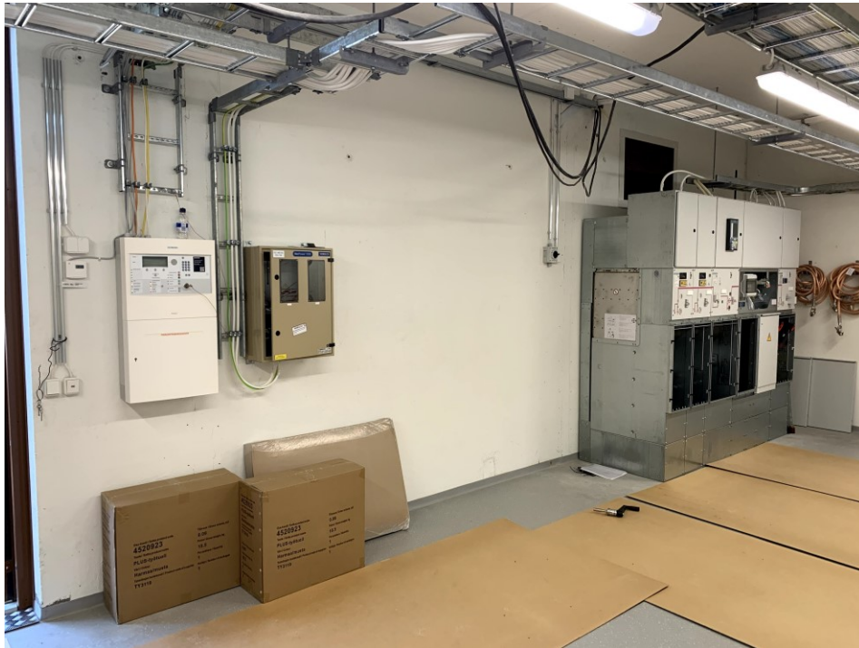
Kuva 9. Helsingin puolen yksi osainen KJ-kojeisto, jossa jakeluverkon rengasverkon osa ja sähköradan puoleinen osa ovat yksi kokonaisuus.
