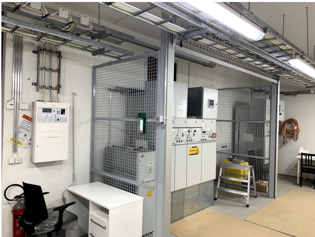
Kuva 8. Espoon puolen kaksi osainen KJ-kojeisto. Sähköverkkoyhtiön omistama osuus on rajattu muusta laitetilasta kalteriseinin. Kalterikopin takana näkyy sähköradan päämuuntajaa syöttävä D-katkaisijakenttä.
