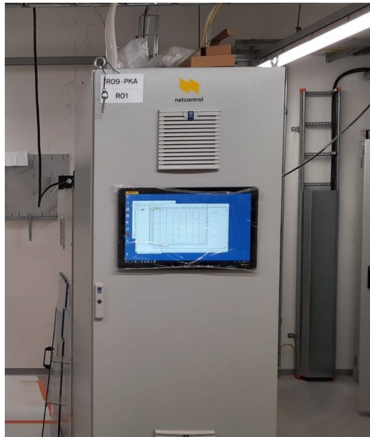
Kuva 13. Kaukokäytön ala-asema, jossa HMI käyttöliittymä.
