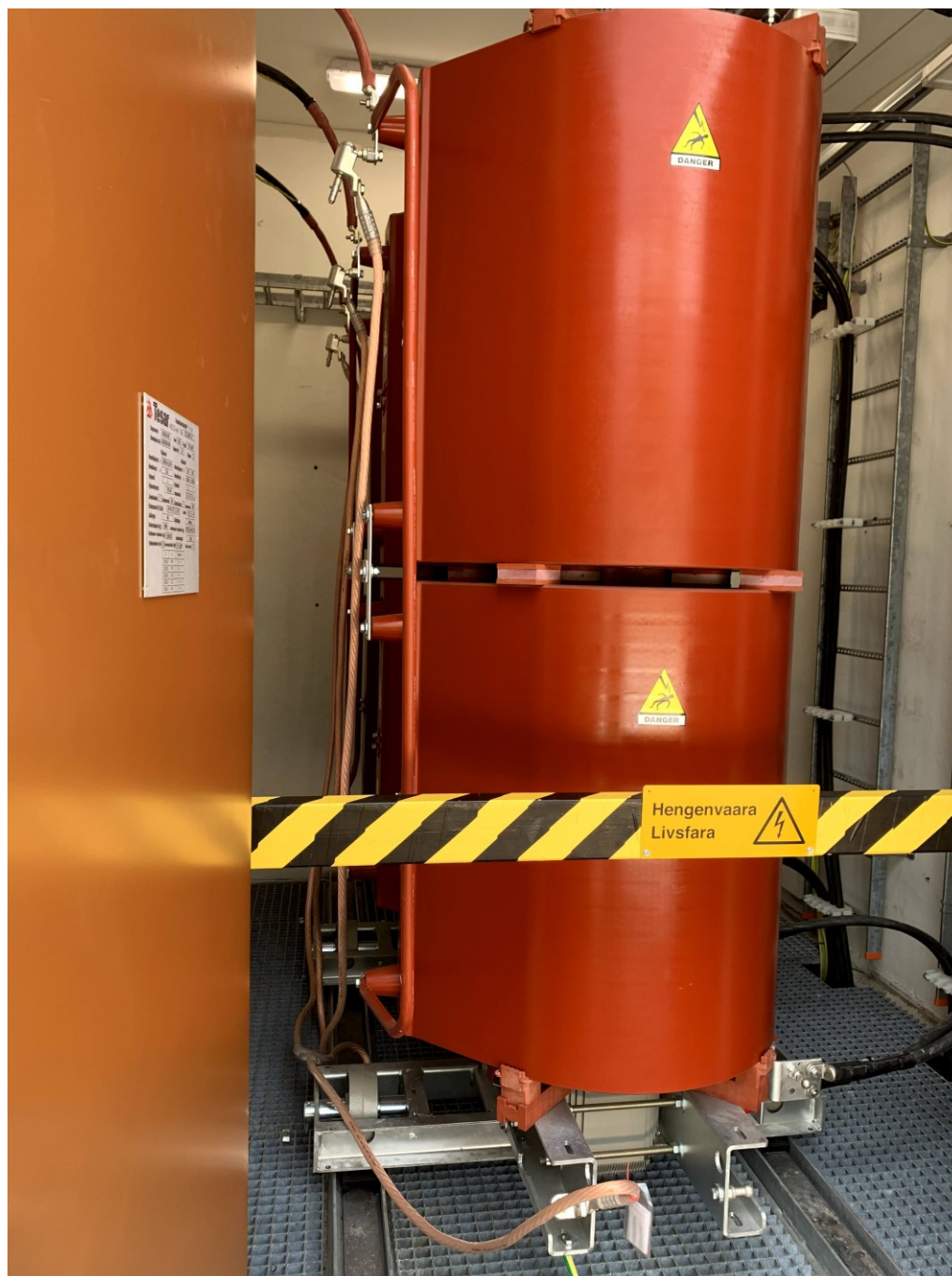
Kuva 10. Ensiöpuolelta työmaadoitettu SSA:n päämuuntaja.
