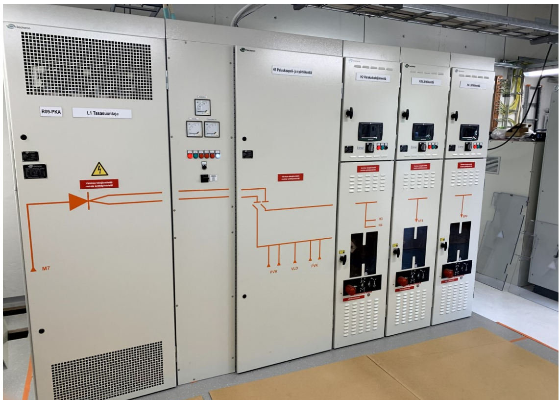
Kuva 12. DC-kojeisto R09-PKA -kennot järjestyksessä vasemmalta oikealle: tasasuun- taaja, paluuvirtakenttä, varakatkaisijakenttä ja lähtökentät H3 ja H4
