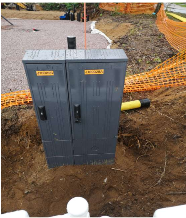
Kuva 10. Yhdistelmäkaappi yhdellä mittauskeskuksella. (25.)
