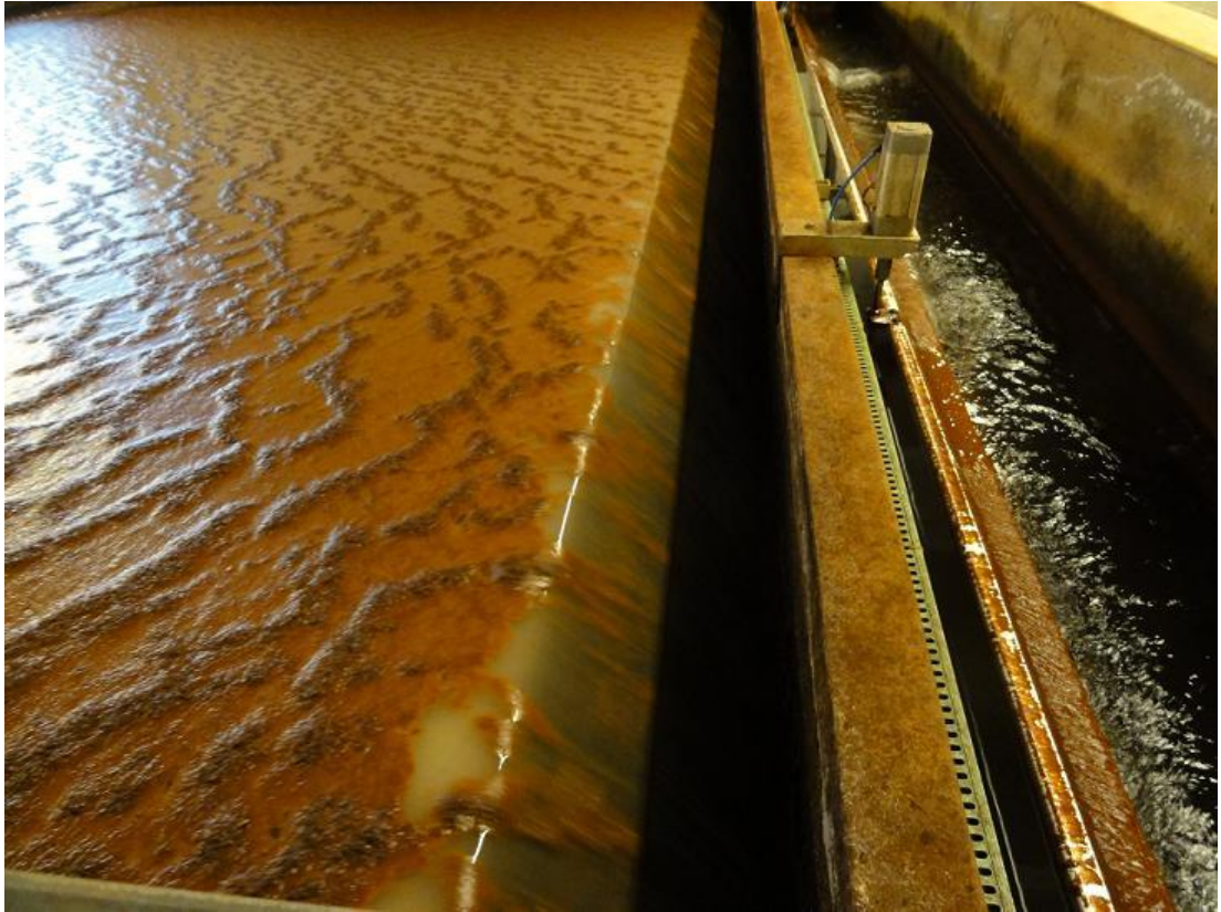
KUVA 7. Liete poistuu viemäriin Hintan vedenpuhdistamolla
