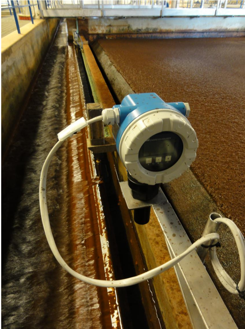
KUVA 12. Valittu pinnankorkeusanturi asennettuna Hintan vedenpuhdistamolla
