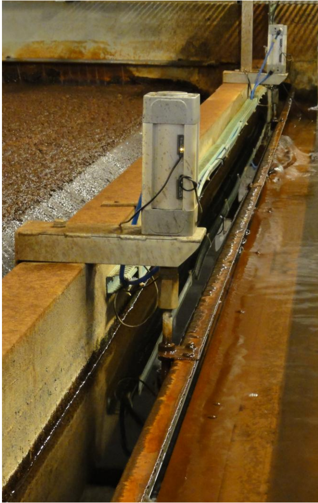
KUVA 10. Flotaatioaltaan säätöpadon paineilmasylinteri
