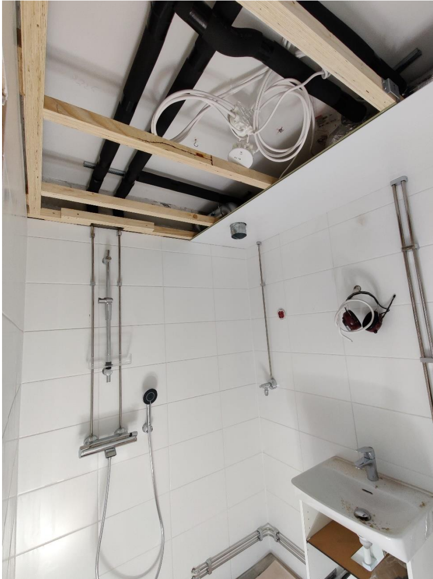
Kuva 16. LVI-asennukset alakatossa eristettynä solukumilla.
