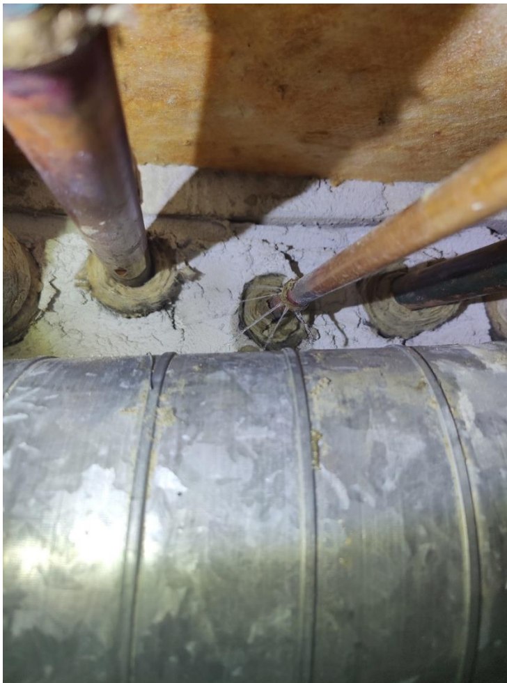
Kuva 12. Putkivuoto kotelon purun yhteydessä talon 10 rengasvarastossa.
