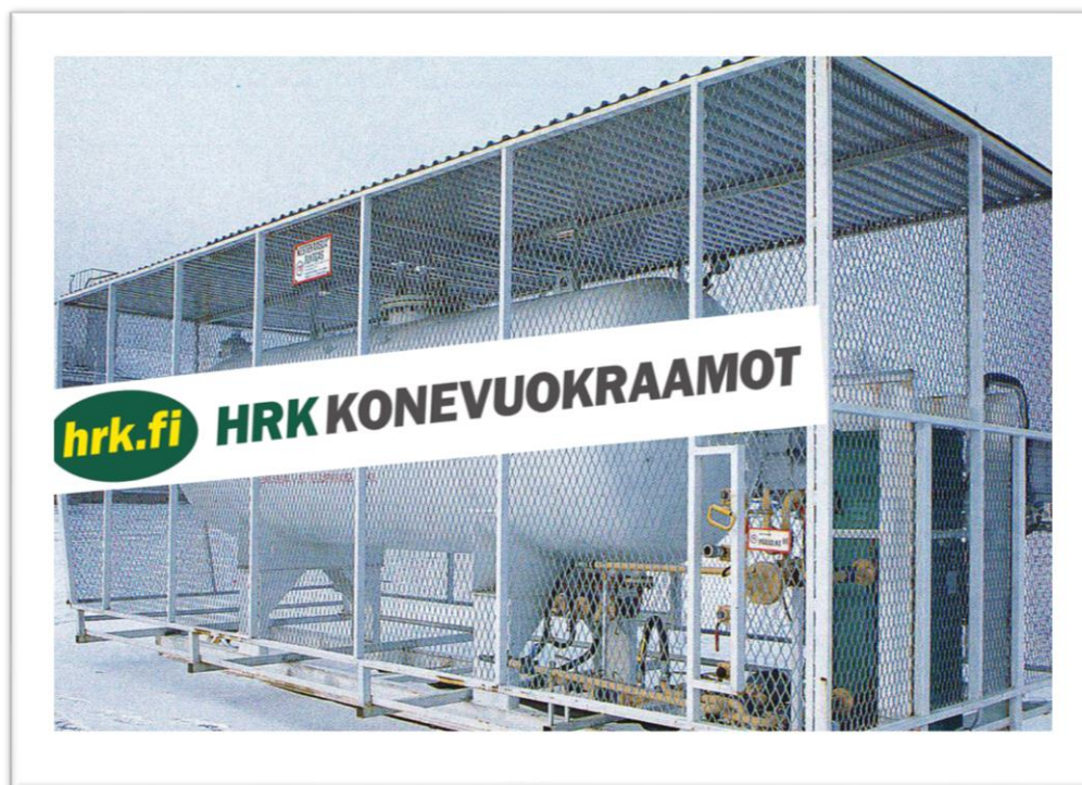
Kuva 9. Kuvassa on niin sanottu ”bulk” nestekaasusäiliöjärjestelmä. Se tulee aidata.
