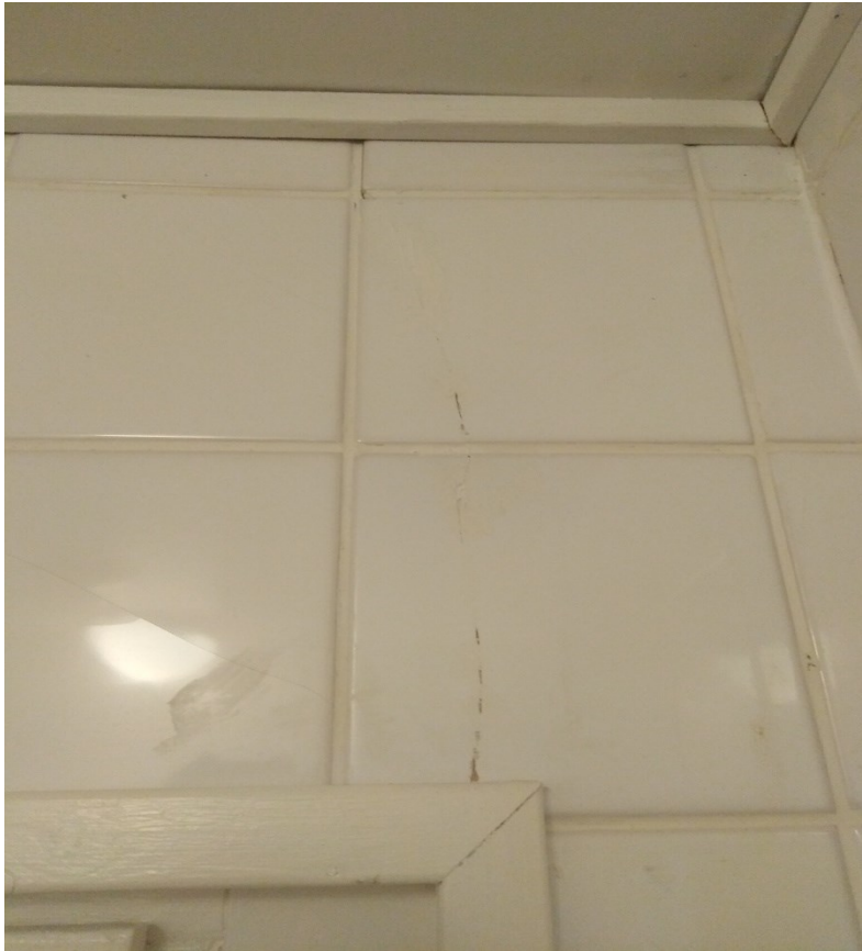
WC:n ja kylpyhuoneen laattapinnoissa on halkeamia
