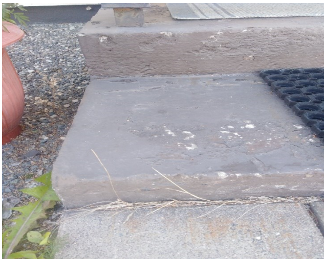
Betonirappusista on lohkeillut betonia pois
