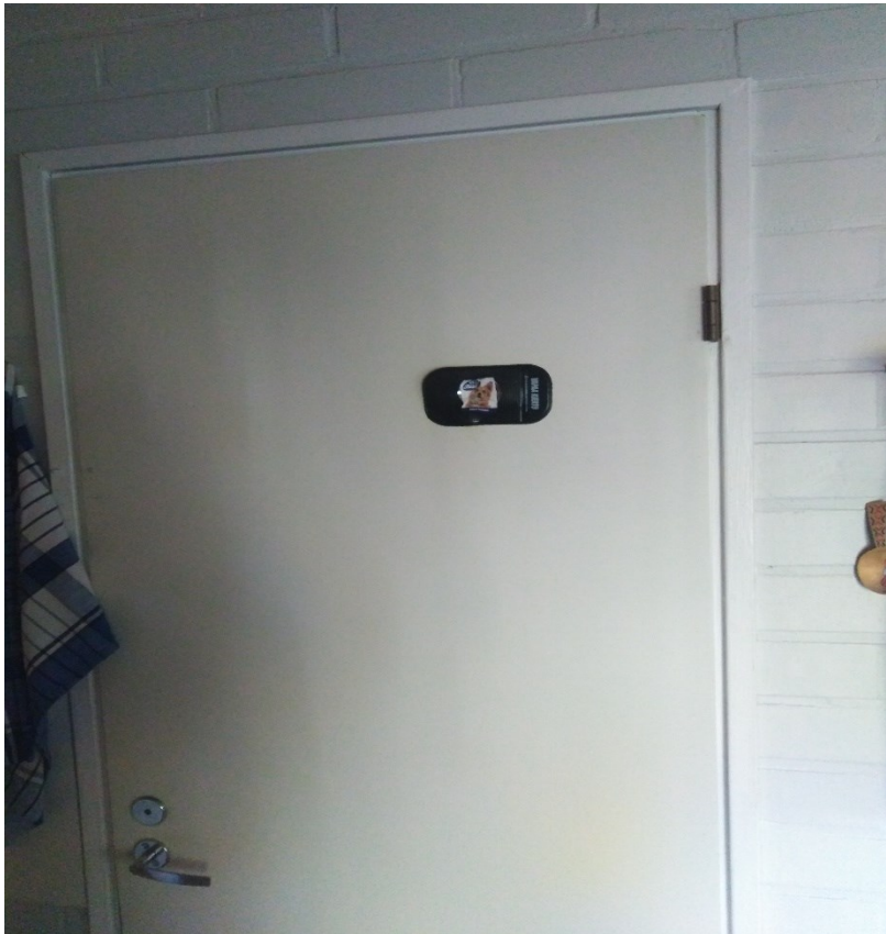
Ovessa on reikä ja se on paikattu väliaikaisesti tarralla
