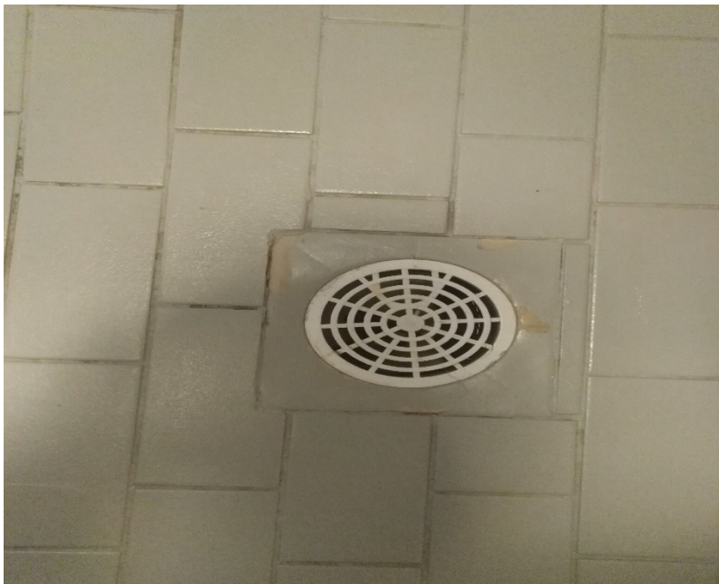
Kylpyhuoneen lattiakaivon ympäriltä on laattamaali irronnut
