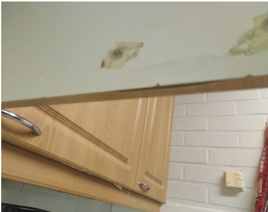
Keittiön kalusteista on pinta rikkoutunut
