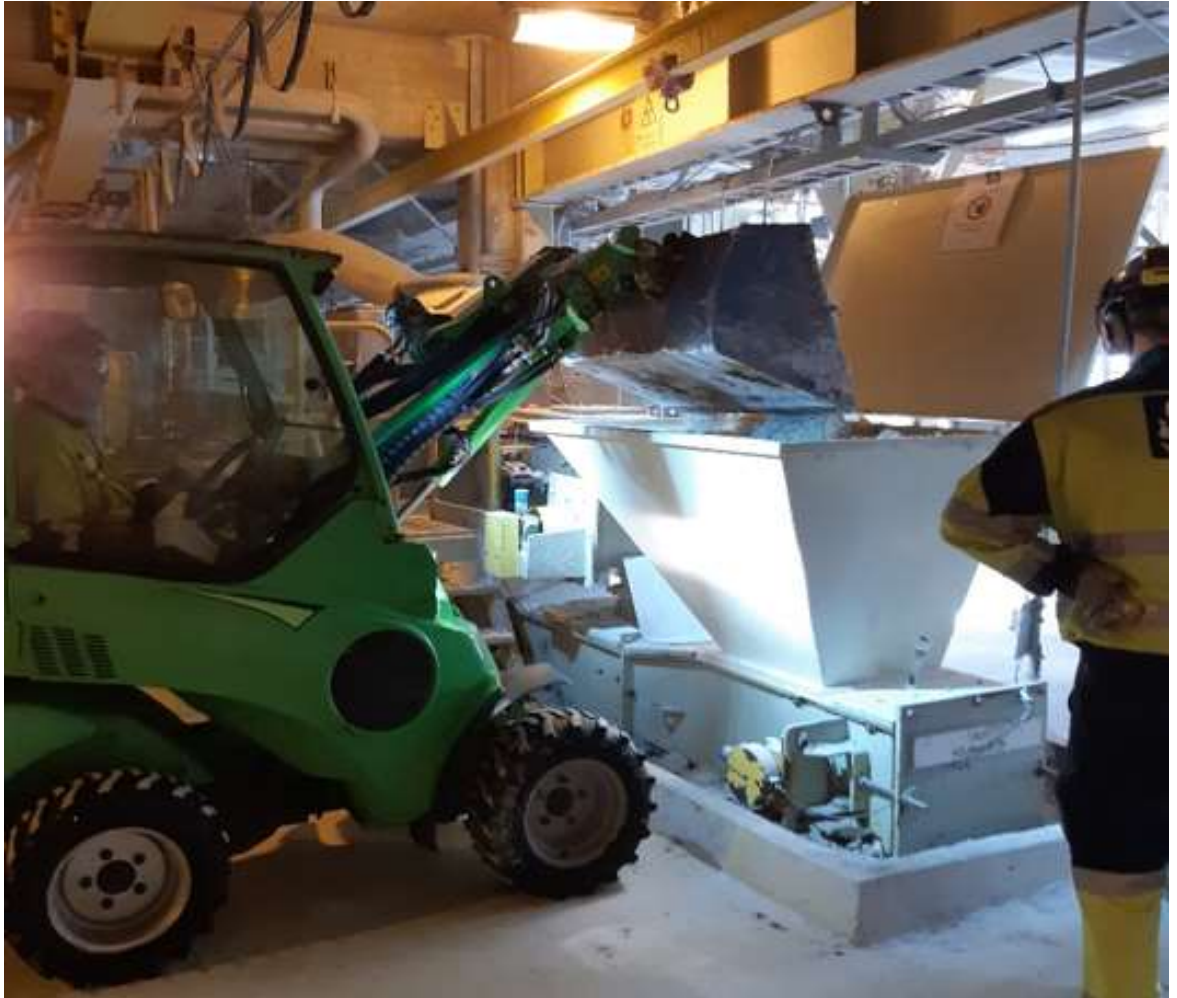
KUVA 13. Kierrätyspuppilo asennettuna ja koeajossa.
