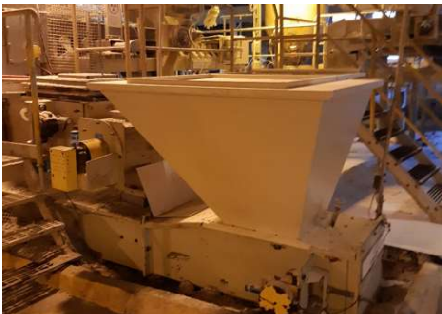
KUVA 12. Kierrätyspuppilo ketjukulakuljettimen päällä asennettuna.
