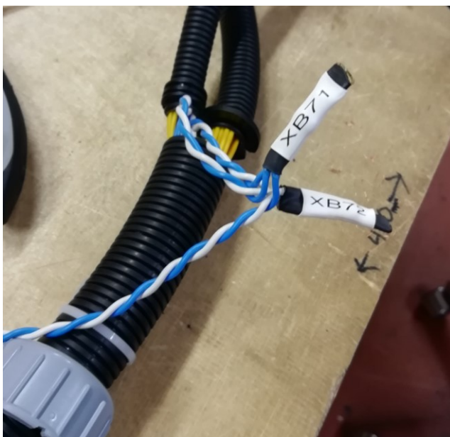
Kuva 19. Haaroituspisteiden merkinnät. Haaroituspisteet merkitään yksilöllisesti. Tämä helpottaa vianhakua, kun haaroituspisteiden sijainnit ovat dokumentoituina.
