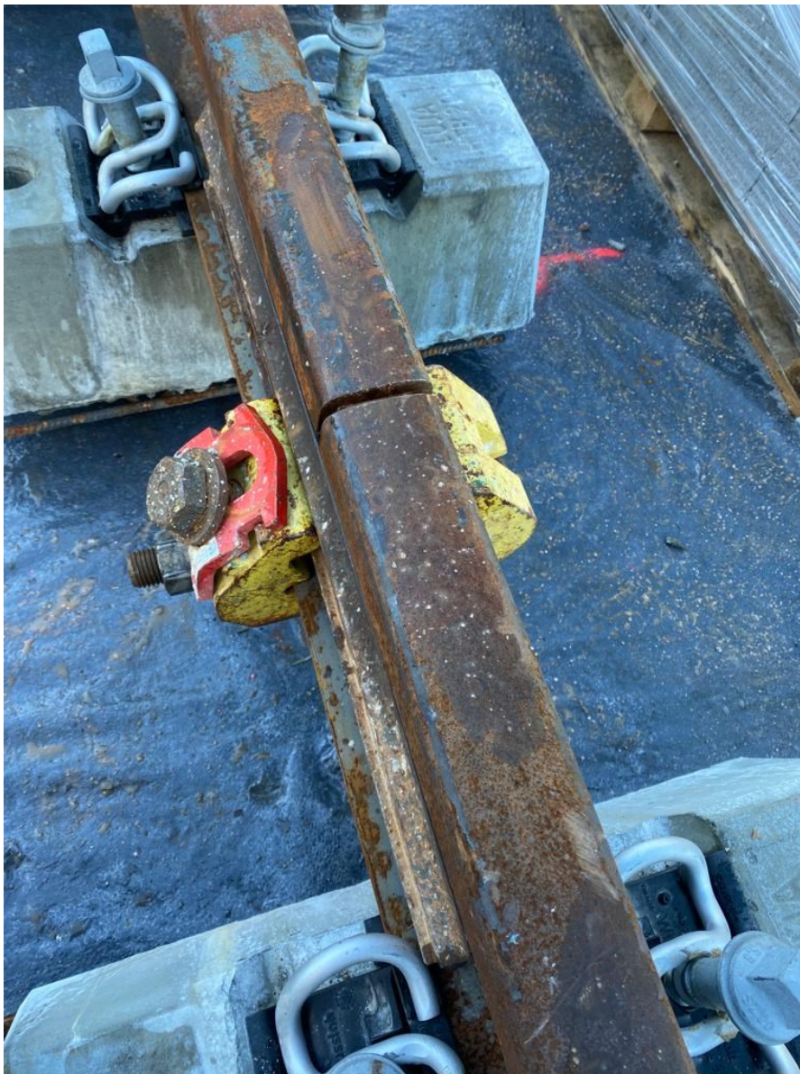
Kuva 2, 49E1-kiskon sidekiskot ja kiskopuristin sekä pölkkyssä oleva kiskon kiinnitysjärjestelmä. Kuva: Arttu Kettunen
