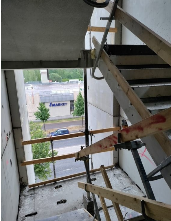
Kuva 6 - Porraskäytävän putoamissuojaus, holvinreunakaide.
