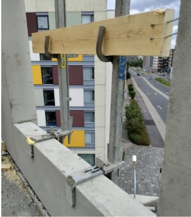
Kuva 4 - Parvekkeen putoamissuojaus, kuorielementtikaide.
