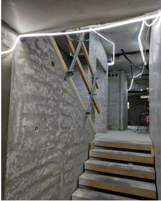
Kuva 12 - Valaistus ledinauhalla porraskäytävässä.
