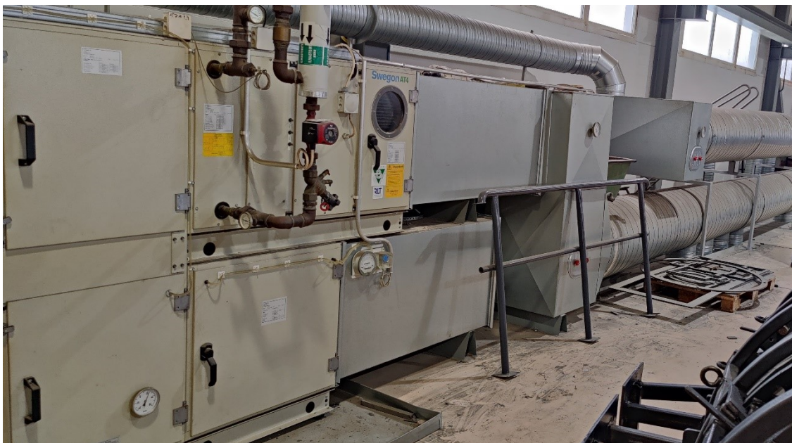
Kuva 7. Vaahdotustilaa palveleva ilmanvaihtokone.
