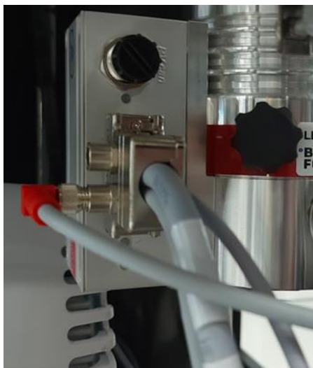
Kuva 32. Tuulettimen kaapeli kytkettynä oikein
