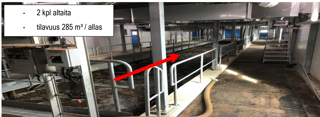
KUVA 9. Hiekanerotusallas ja nuoli osoittamassa jäteveden kulkusuunnan
