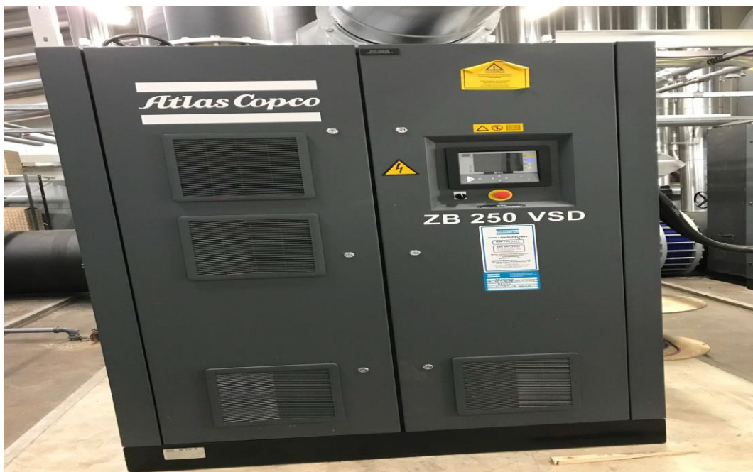
KUVA 30. Ilmastuslaitaiden kompressorit Atlas Copco ZB 250 VSD
