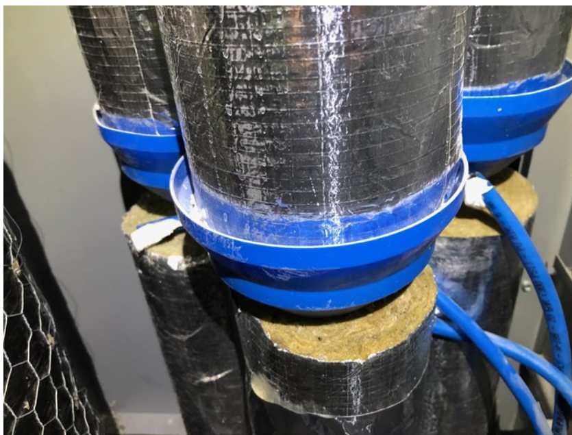
Kuva 34. Kylpyhuone-elementin vuotovesiletku voi mahdollisesti eristystyövaiheen aikana irrota pois paikaltaan. Aliurakoitsijan kanssa kannatta etukäteen sopia niin tarkistamisesta. Myös työnjohtajien kannattaa ja täytyy olla tarkkaavaisia näiden suhteen. (YIT:n Vastaava työnjohtaja Hakkarainen, 2021.)
