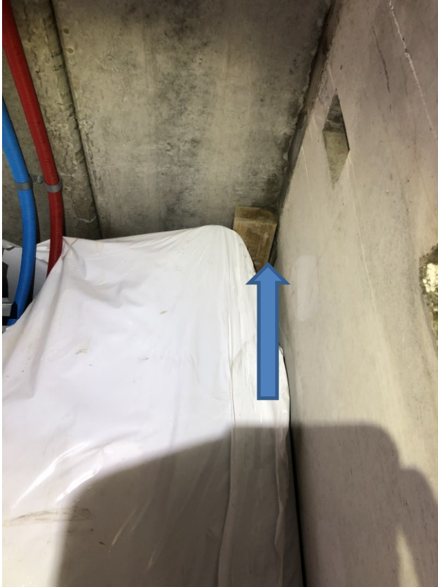
Kuva 35. Kylpyhuone-elementin katorakenteissa on puupalikka asennettuna, joka homehtuu helposti runkotyövaiheenaikana. (Sillanpää, 2021.)
