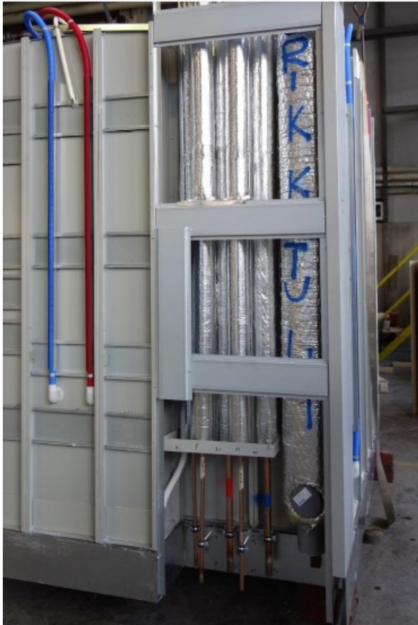
Kuva 14. Kylpyhuone-elementin tekniikkahormi, jossa on LVIS-tekniikka. LVI-putkien päistä on jätetty asentamatta eristeet, koska rakennustyömaalla nämä kytketään rakennuksen tekniikkaan kiinni. (Sandström, 2019: 9.)
