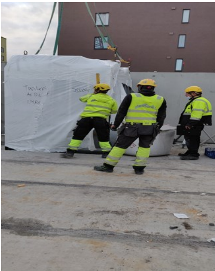
Kuva 23. Ensimmäisestä kylpyhuone-elementistä on menossa mallielementti-asennus. Parmarinen asennusohjaaja opastamassa ja tekemässä malliasennuspöytäkirjan. (Sillanpää, 2021.)
