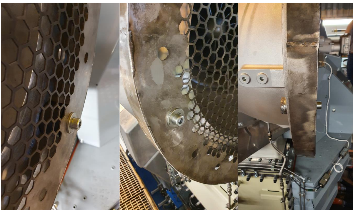
Kuva 10. Vanhan suojaritilän kiinnitys.
