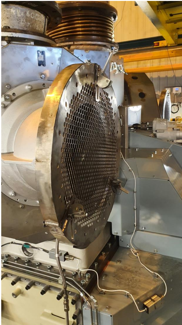
Kuva 18. Imukäyrän suojaritilän testaus koeajossa.
