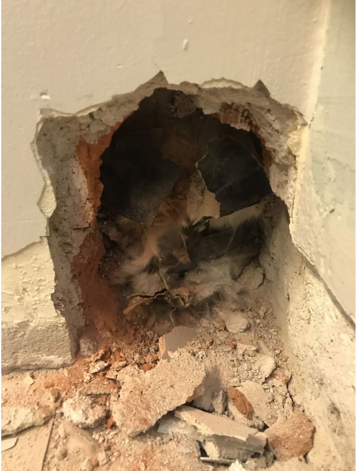
Kuva 2. Asbestia sisältävä seinäeriste (Sjöberg 11/2019)
