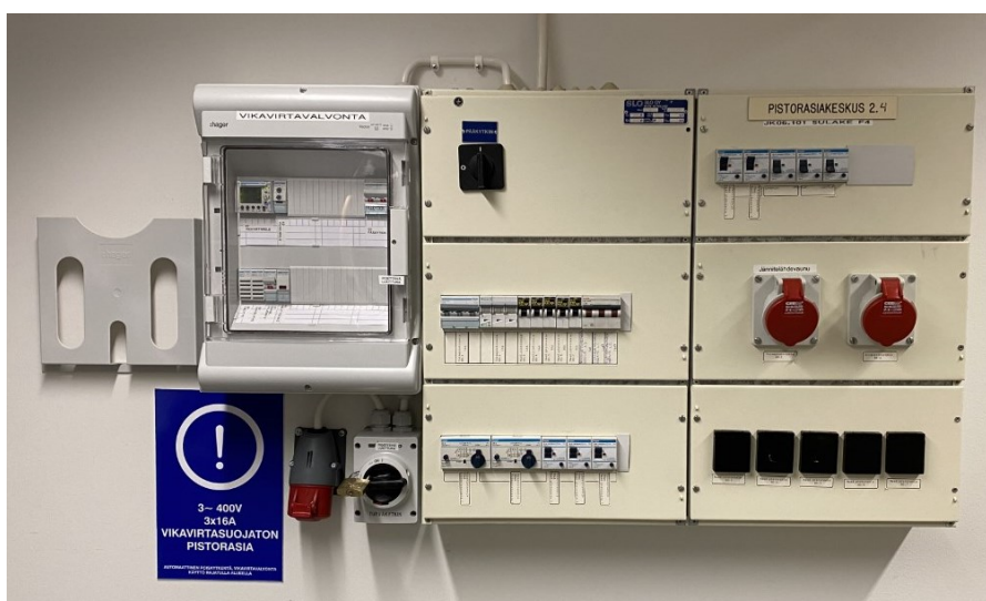
Kuva 24. Vikavirtavalvonta -yksikkö asennettuna.
