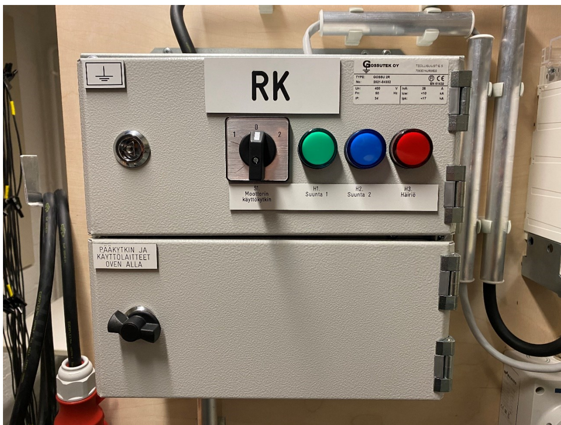
Kuva 13. Asennusseinä 2, keskus RK 2R, nokkakytkin ja merkkilamput.
