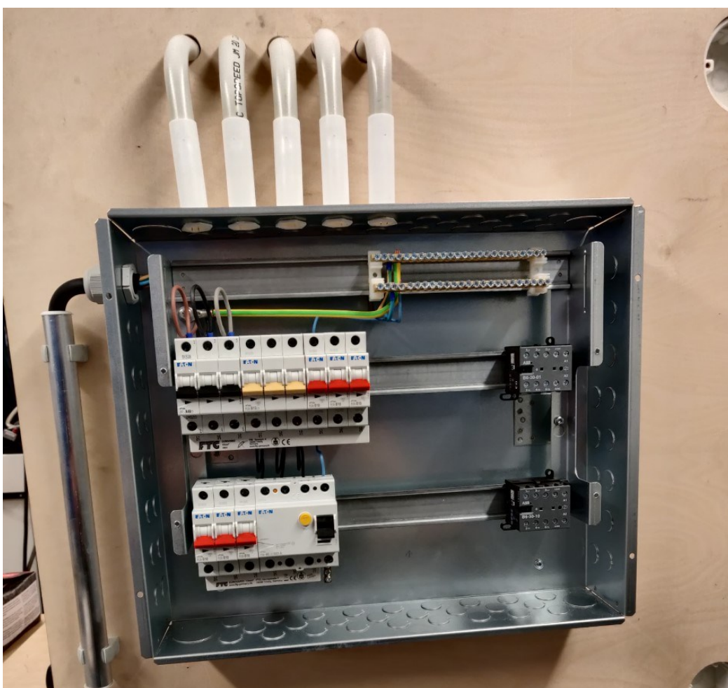
Kuva 12. Asennusseinä 1, keskus RK MINI U2D, suojalaitteet ja kontaktorit.
