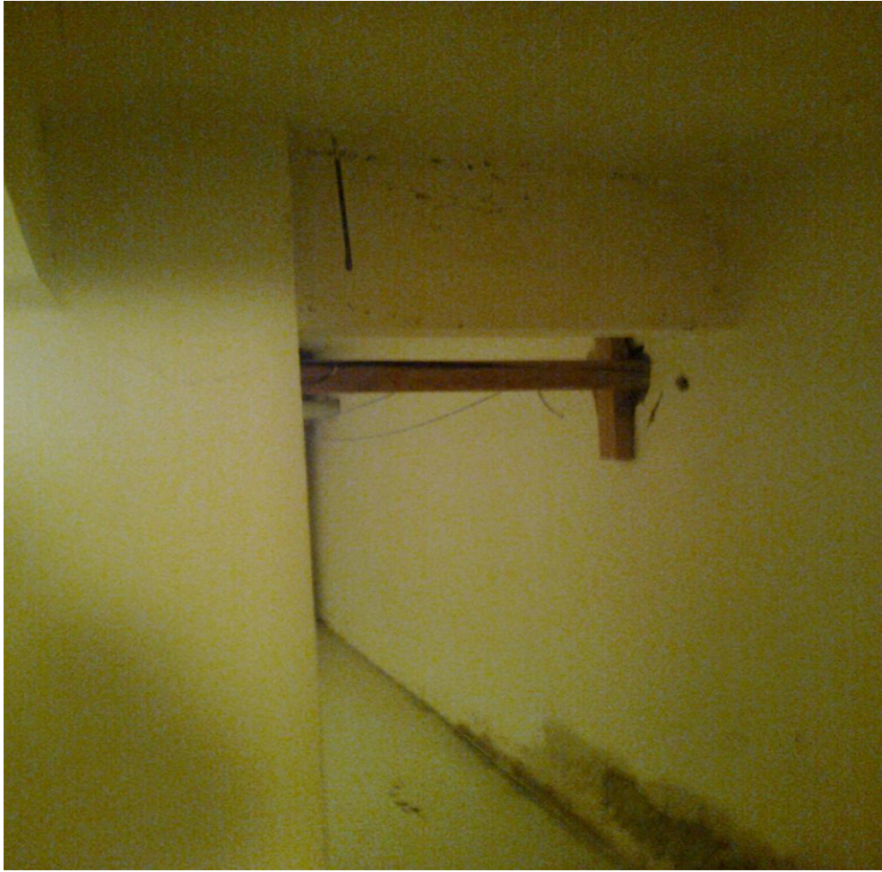
Kuva 4. Kuvassa seinäpintojen vaurioita (Laitinen 2012.)
