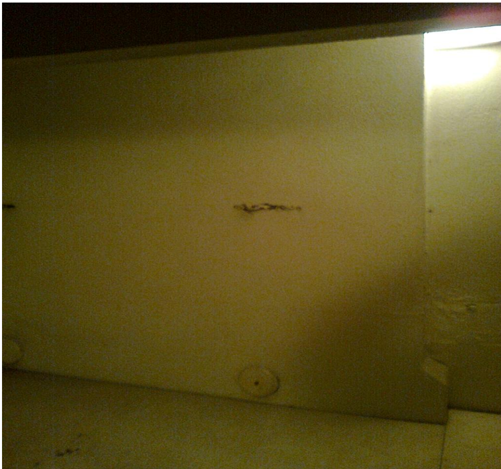
Kuva 15. Nykyisen pesutilan puolella näkyvät vanhat hormit sekä niiden sulkupeltien paikat
