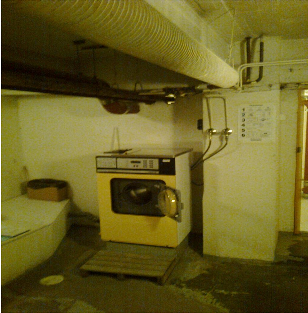
Kuva 3. Katossa riippuvat kaukolämpöputket ovat vailla eristeitä (Laitinen 2012.)
